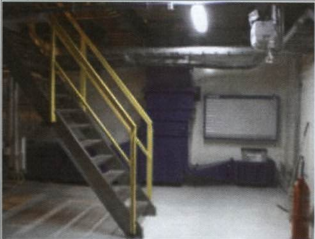
36: Sistema de exaustão
