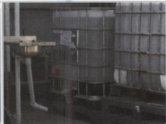
71: Container de Água carbonatada
