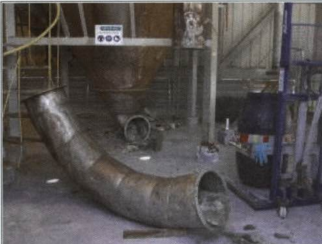
78: Incrustações nos dutos da câmara de secagem
