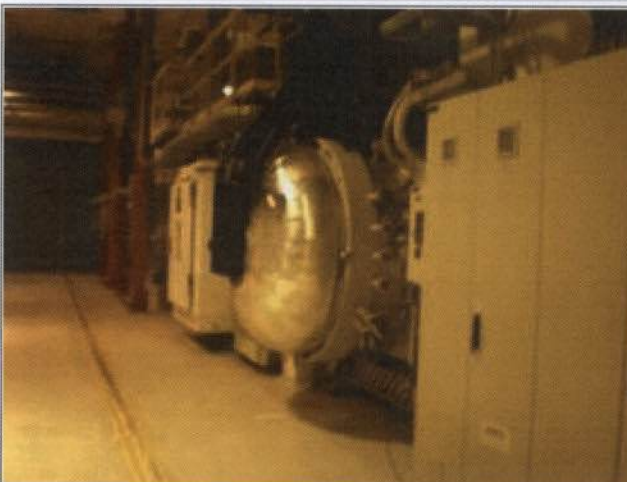
11: Sala de Autoclaves
