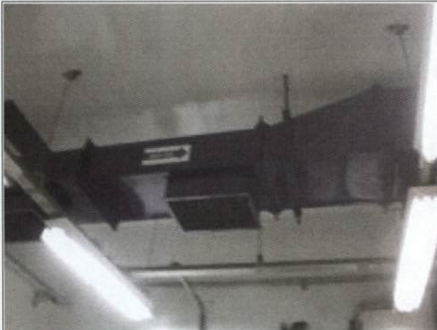
13: Detalhe da corrente SAD-03, de exaustão dos gases até o lavador
