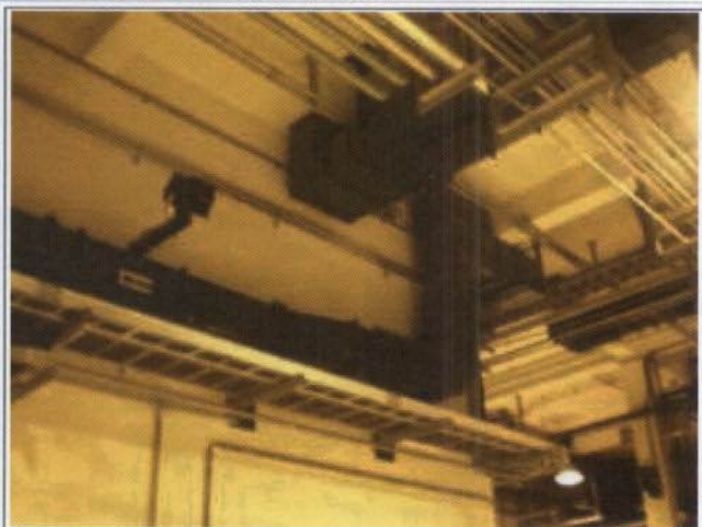
12: Sistema de exaustão na Sala de Autoclaves
