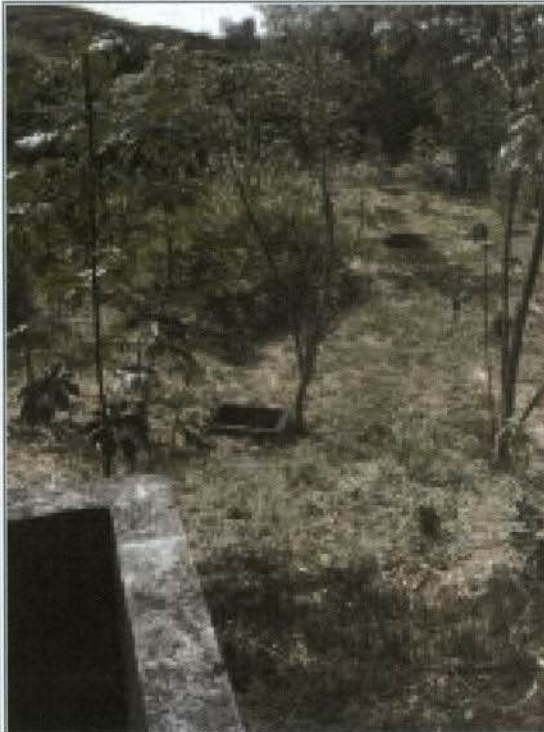
98: Vários poços de visita ou caixas de passagem
