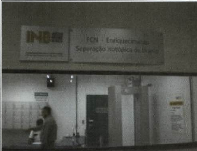
34: Sala de Controle do Enriquecimento
