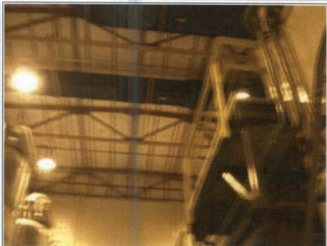
35: Sistema de exaustão
