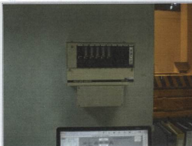
40: Sensores de alarme
