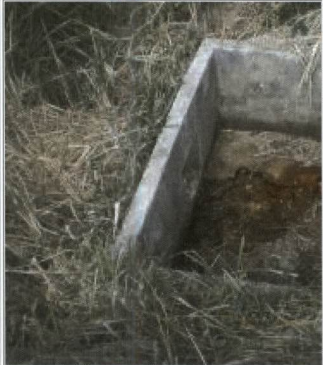
97: Poço de visita para o efluente
