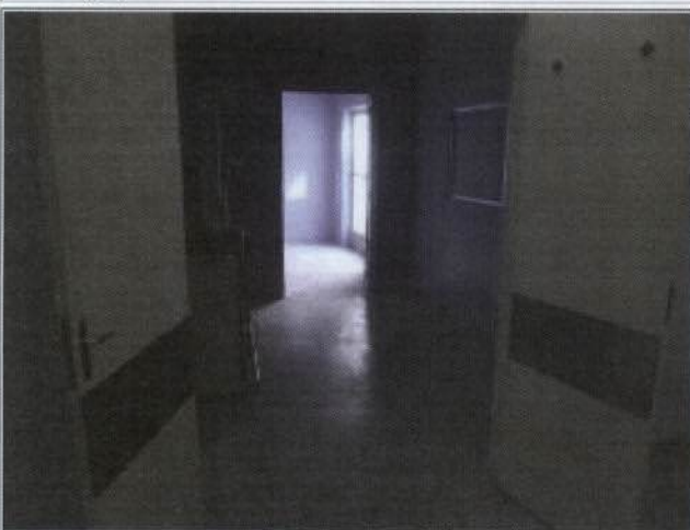
128: Porta de acesso para equipe médica à sala de recepção dos radioacidentados.
