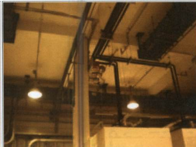
18: Sistema de alarmes
