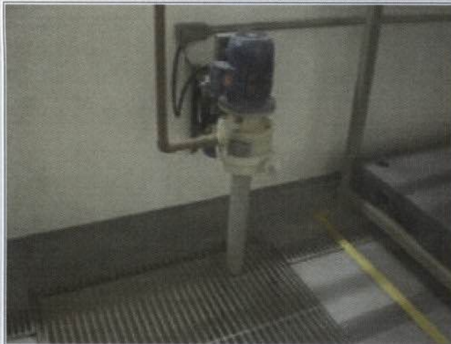
112: Bomba que será acionada em caso de vazamentos
