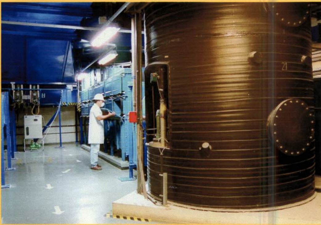
Sistema de Tratamento de Gases
