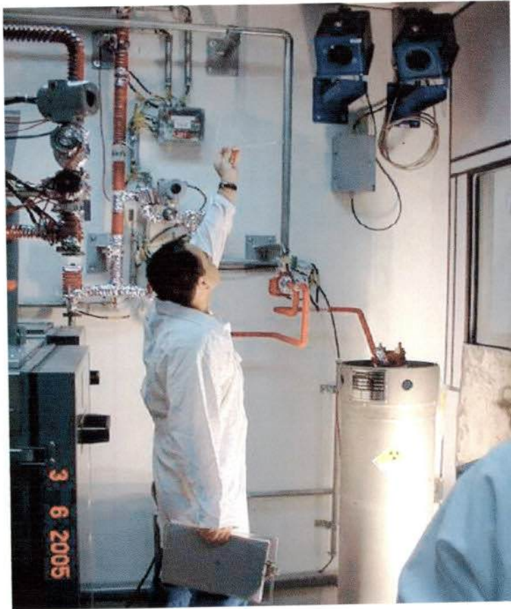
Figura 5: SALA UJE01-101a Sistema de Alimentação Sistema de Vigilância (AIEA e ABACC)
