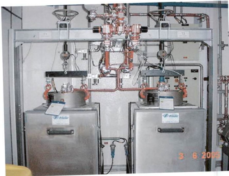
Figura 3: SALA UJE01-101a Estação de Retirada - Empobrecido Visão Geral
