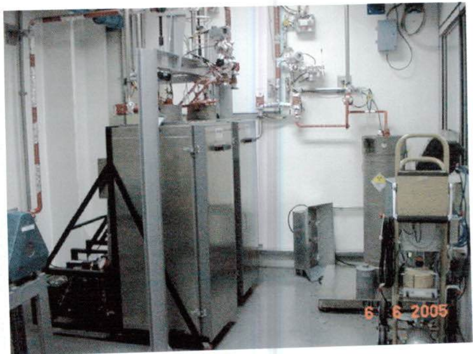
Figura 6: SALA UJE01-101a Sistemas de Alimentação e Estação de Retirada - Enriquecido
