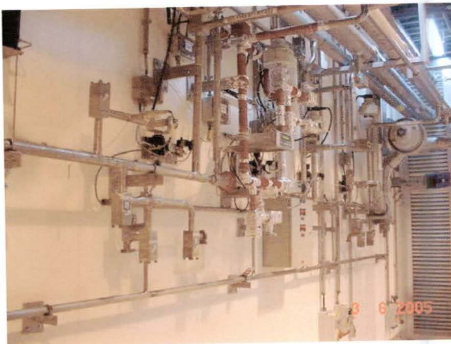
Figura 1: SALA UJE01-101 Ilha de Válvulas - Visão Geral
