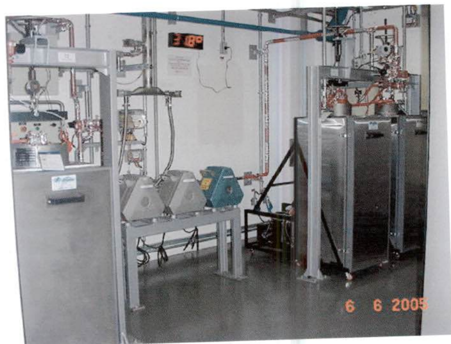
Figura 4: SALA UJE01-101a Estações de Retirada - Visão Geral
