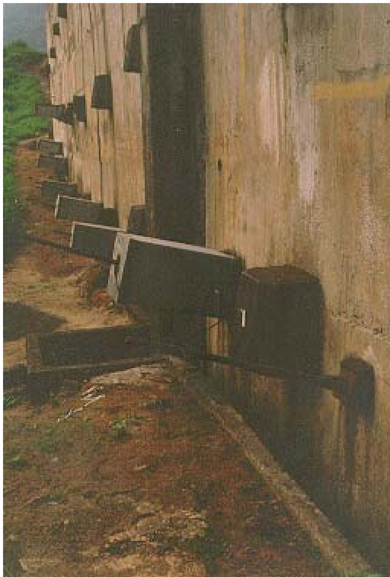
Foto 7 - Detalhe dos tirantes de barra executados para reforço da cortina superior de jusante, e as caixas de proteção das células de carga instaladas (1992).
