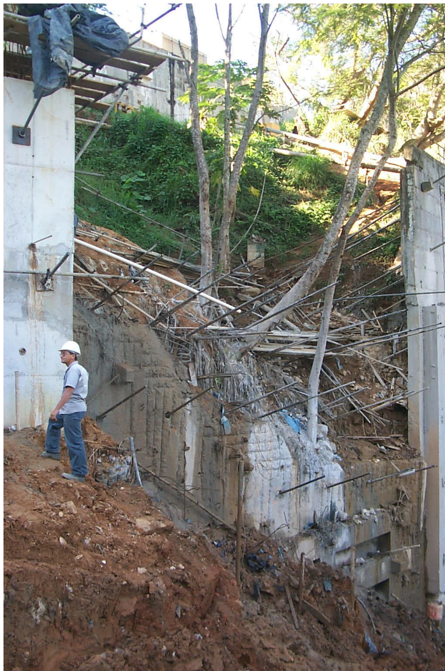
Foto 10 - Início das obras de reforço (julho/2001) mostrando os tirantes de reforço já instalados e os painéis rompidos.
