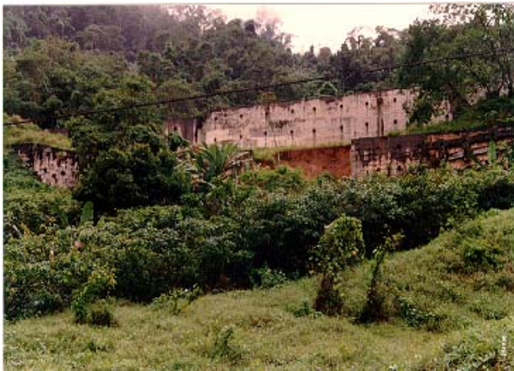
Foto 6 - Painel 6 da cortina inferior rompido em fevereiro/1988.
