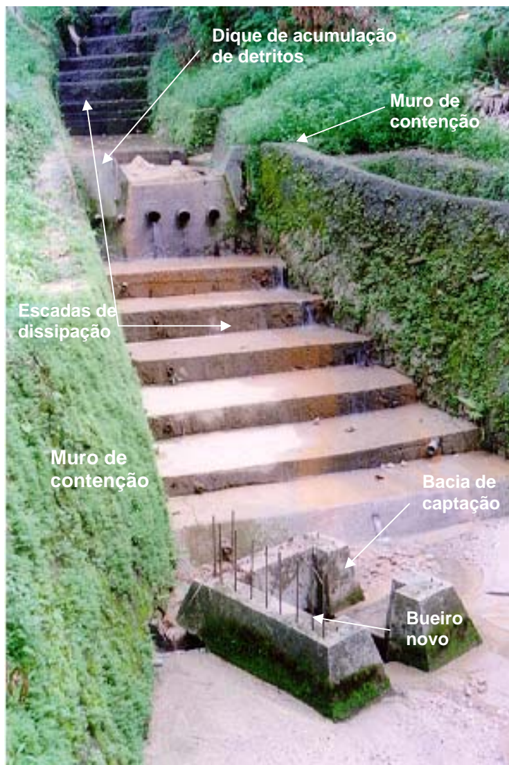
Foto 5 - Sistema de drenagem executado após os desmoronamentos superficiais dos taludes à montante da BR-101, ocorridos em consequência das chuvas intensas de fevereiro /1985.
