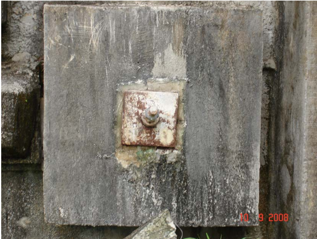
Foto B - Tirante D11, \phi 38mm, painel D da cortina superior de jusante, solto.
