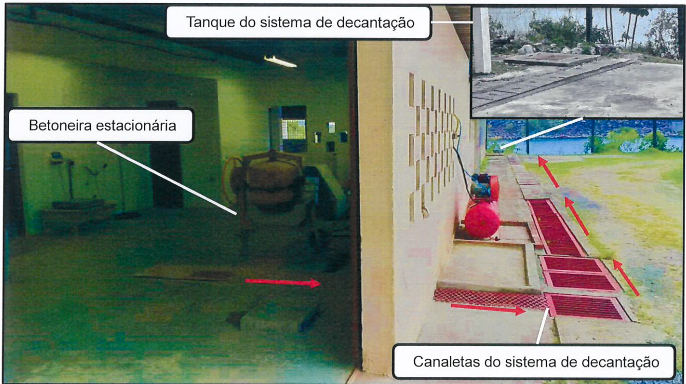
Figura 13: Sistema de drenagem de efluentes do laboratório. Observa-se em destaque vermelho o fluxo de drenagem do efluente oriundo da betoneira estacionária executadas no interior do laboratório de concreto.
