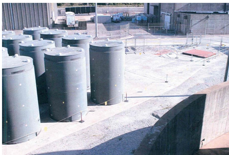
Módulos de Armazenamento a seco de ECIs na Usina Nuclear de Vogtle - EUA
