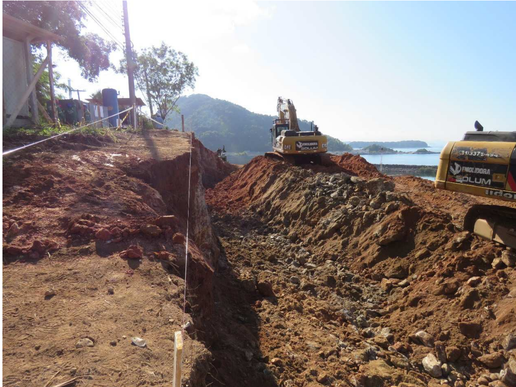
Figura 8. Locação de off set e escavações da crista do talude superior (09/jan/2019).
