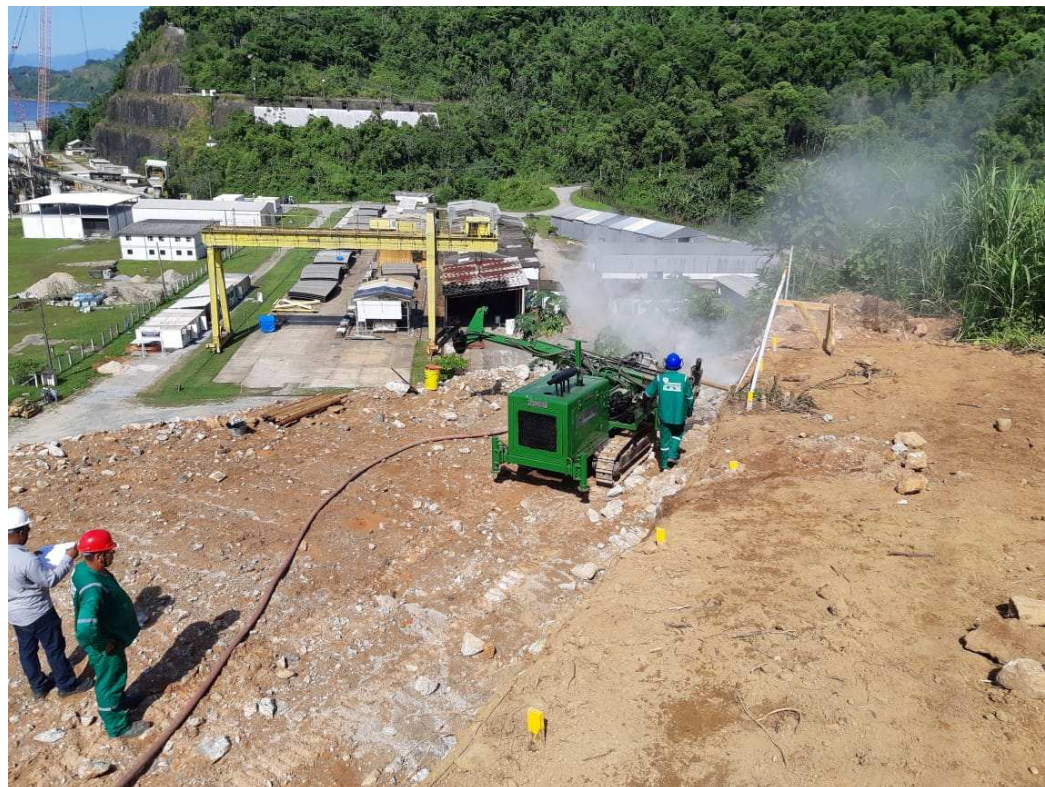
Figura 9. Início das atividades de perfuração dos furos de chumbadores da linha 01 na Seção 02 (09/jan/2019).
