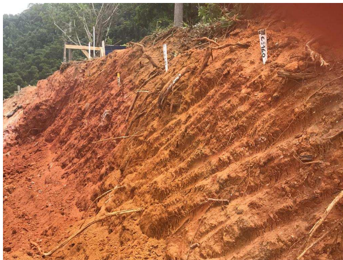
Figura 7. Escavações iniciais na crista do talude superior com variação dos materiais (04/jan/2019).
