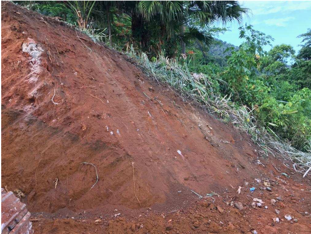
Figura 11. Furo de chumbador na Seção 10, na esquerda hidráulica do talude, vizinho ao talvegue da encosta (10/jan/2019).
