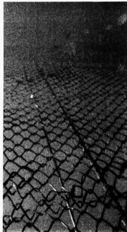
Figura B9. Tela de inox reparada.
