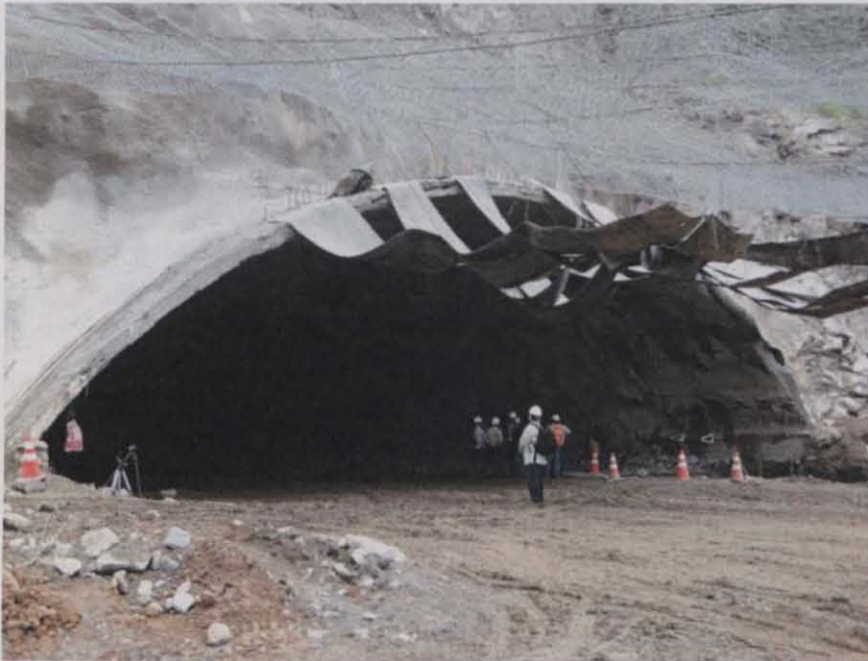
Figura 3.2. Cobertura com tela metálica de alta resistência e painéis de borracha no emboque do Túnel Porto Sudeste.
