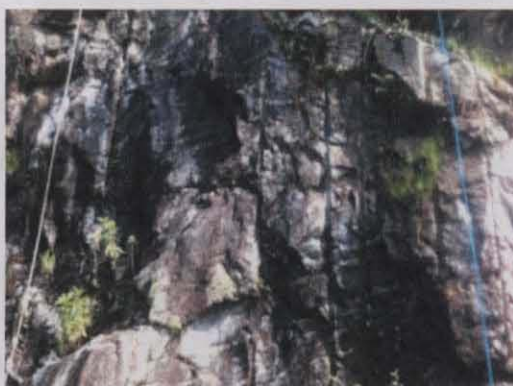
(d) Fraturas de fogo de desmonte
