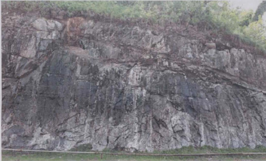
Figura 2.14. Talude rochoso após limpeza da superfície, com realce das juntas intemperizadas em 2017.
