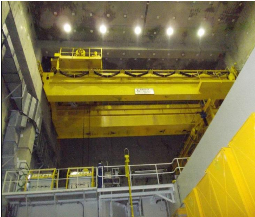
Figura 4-70 - Ponte Rolante do Prédio de Combustível (Angra 1).
