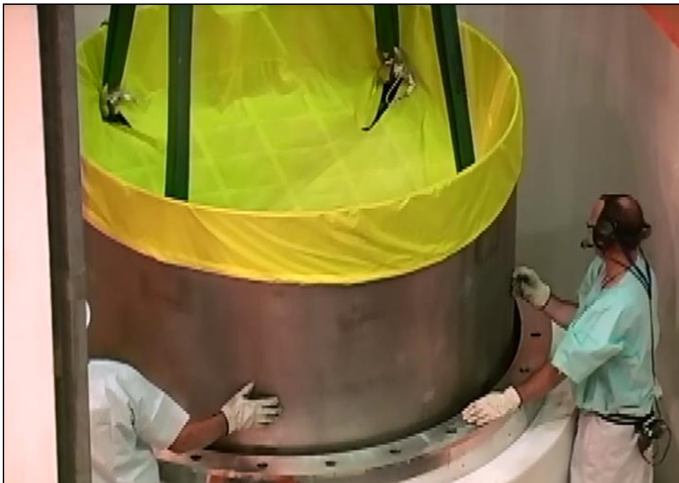
Figura 4-23 - Posicionamento do Canister no interior do Casco de Transferência
