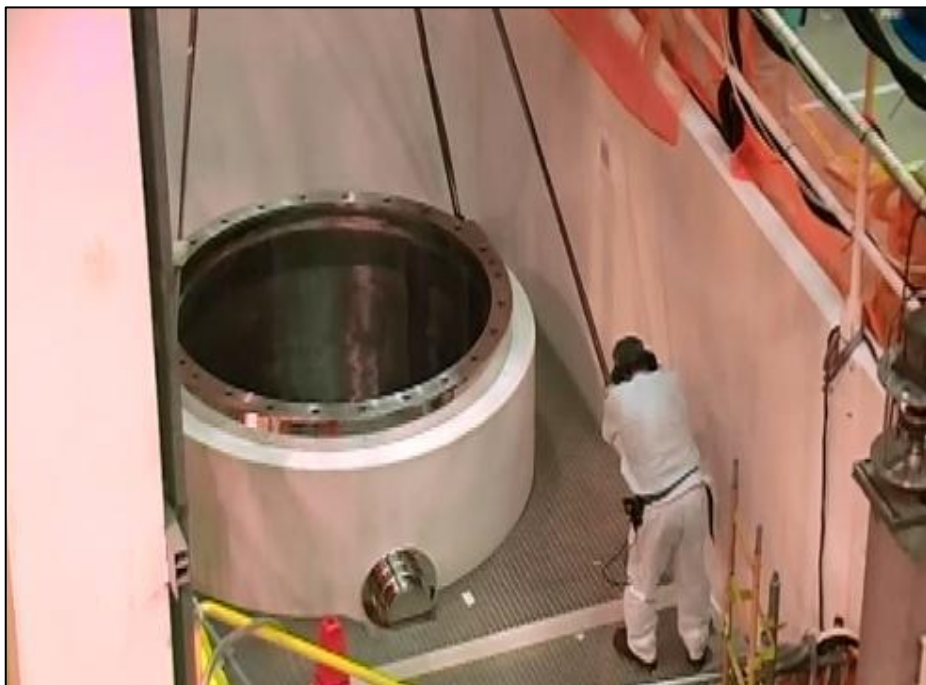
Figura 2-19 - Canister no interior do Casco de Transferência através da Ponte Rolante
