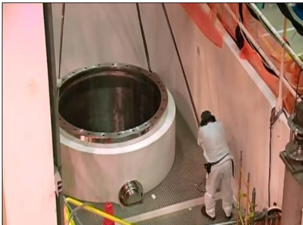
Figura 4-39 - Canister no interior do Casco de Transferência através da Ponte Rolante.
