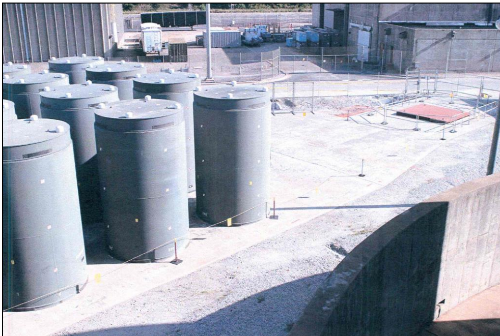
Figura 4-4 - Módulos de Armazenamento a seco de ECIs na Central Nuclear de Vogtle
