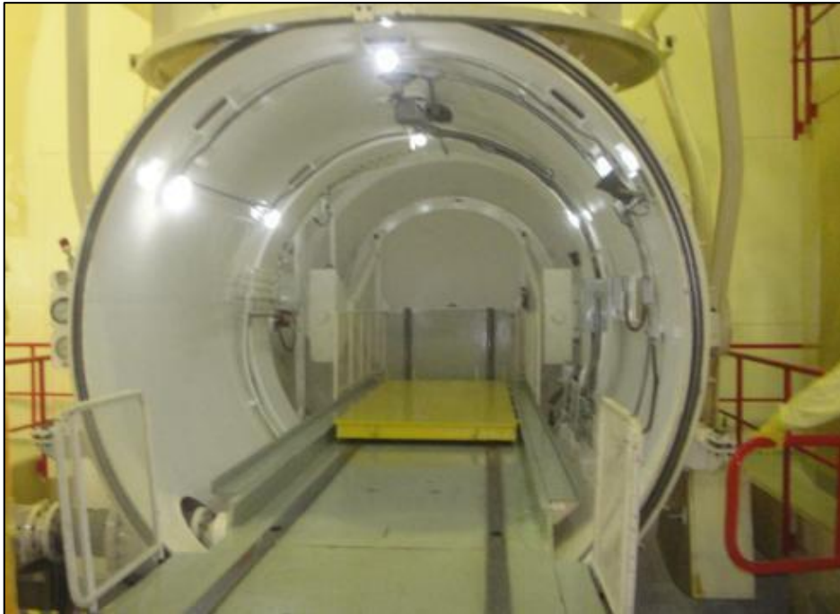
Figura 2-18 - Eclusa de Equipamentos
