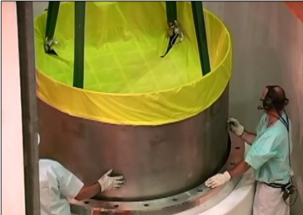
Figura 2-3 - Posicionamento do Canister no interior do Casco de Transferência
