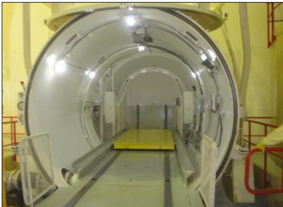
Figura 4-38 - Eclusa de Equipamentos.
