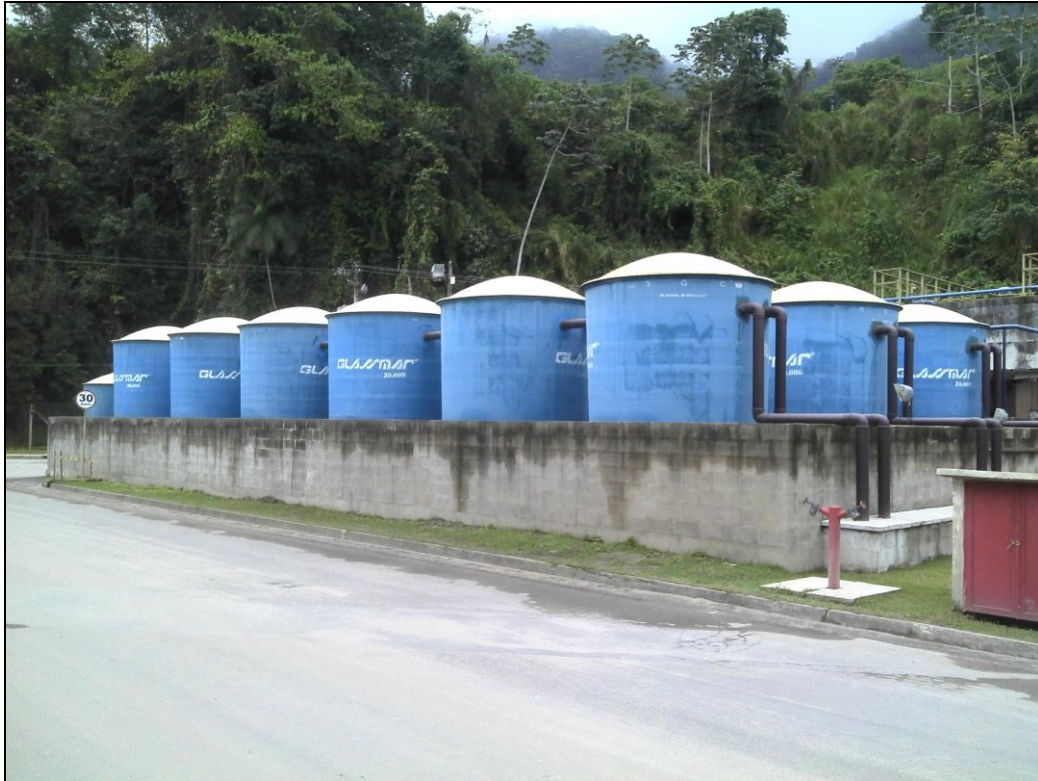
Figura 4-85 - ETE provisória do canteiro de obras de Angra 3
