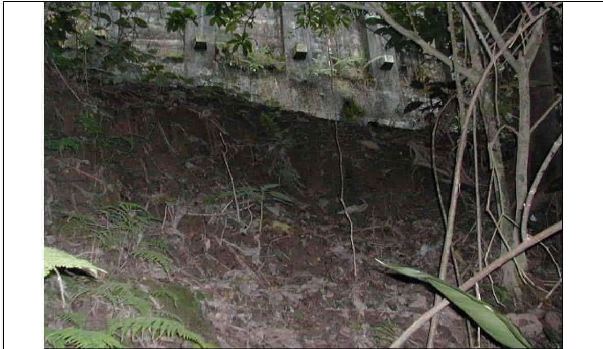
Figura 111 – Foto do processo erosivo na base da cortina do ponto 11A da folha 1.
