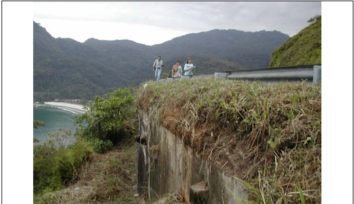
Figura 115 - Cortina do km 522,6 executada pelo DNIT (antigo DNER) à jusante da BR-101. Fonte: “Levantamento e Diagnóstico Ambiental (Meio Físico) da Área de Influência da CNAAA – Vol II (Eixo 2 – Geologia e Recursos Hídricos)”, IGEO/UFRJ.
