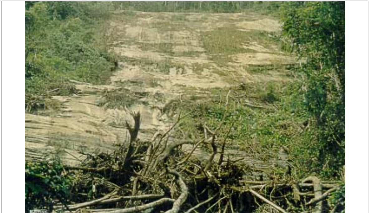
Figura 109 – Foto do afloramento maior assinalado na foto da Figura 108, resultado de um escorregamento ocorrido em janeiro de 91, em que se observa o migmatito fraturado e a presença de delgada camada de solo orgânico, apesar da densa vegetação existente (1991).
