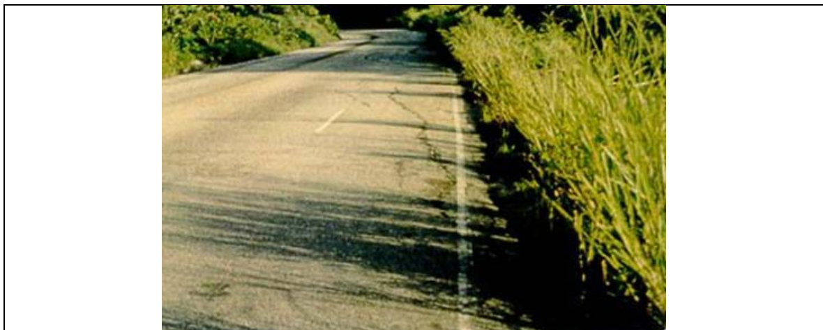
Figura 129 – Foto das trincas na rodovia no ponto 3 da folha 3 do ano de 1991.
