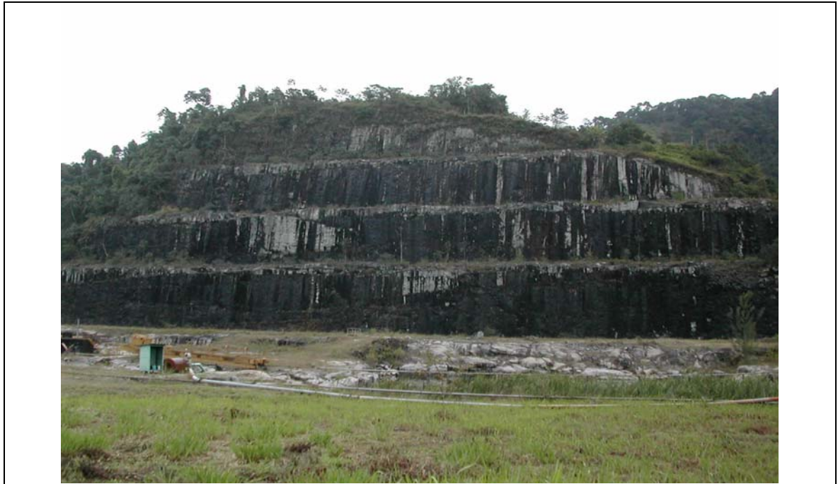
Figura 117 – Área de construção da Usina Nuclear de Angra 3, apresentando corte em gnaisses migmatíticos escavado em quatro bancadas de 15,0 m.
