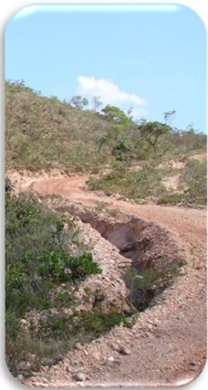
Erosão em sulco em estrada com acesso ao córrego Lamarão.
