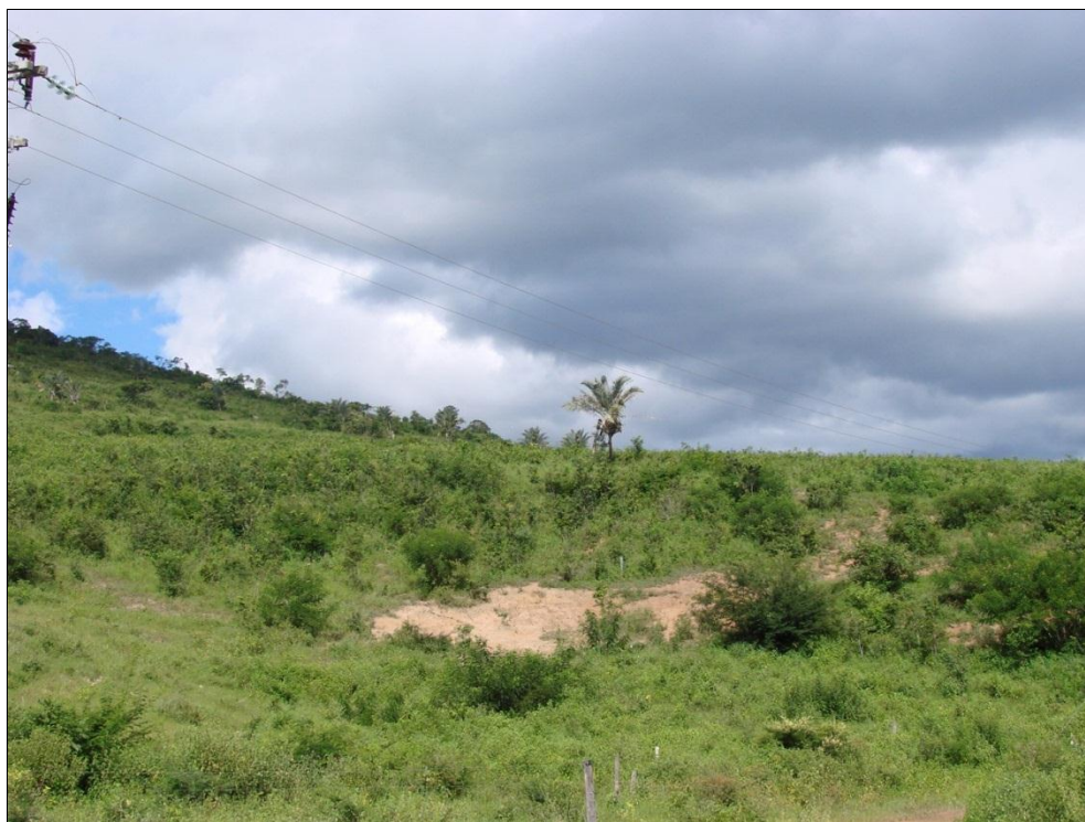
Foto 10.23 - Erosão laminar nas proximidades do eixo do Mineroduto, limite sul do município de Vitória da Conquista (280.184/8.290.907 - 24L).
