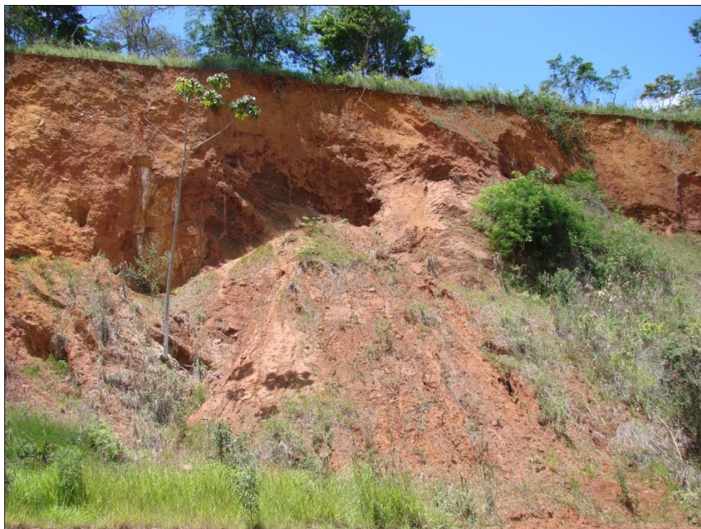
Foto 10.28 - Deslizamento em perfil de Argissolo Vermelho-Amarelo na margem da estrada vicinal, a qual o Mineroduto margeia. A diferença estrutural da rocha é o indicativo mais provável para o deslocamento do horizonte B, preservando parte do horizonte A.
