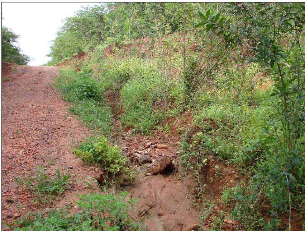
Foto 10.57 - Vale do rio Tabocas, no município de Salinas, mostrando ravina na beira da estrada. No entorno foram observados alguns pequenos desmoronamentos em taludes - 797.638E / 8.232.310N - 23K.
