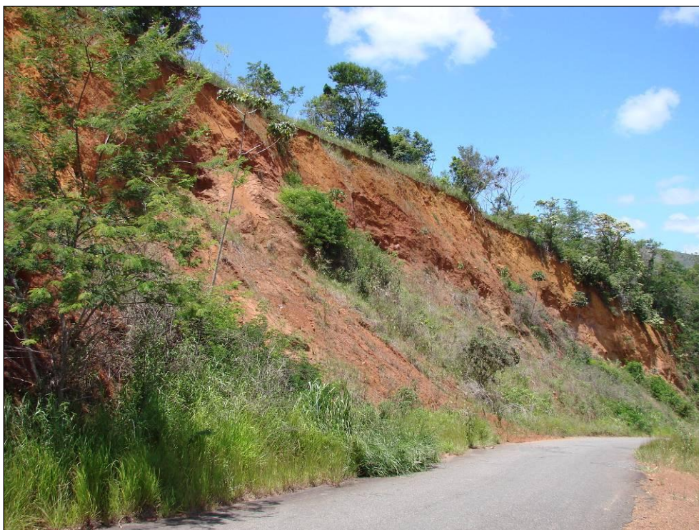
Foto 10.63 - Deslizamento de terra em talude de estrada, vale do córrego Jabuti, município de Ribeirão do largo - 314.001/8.305.847 - 24L.
