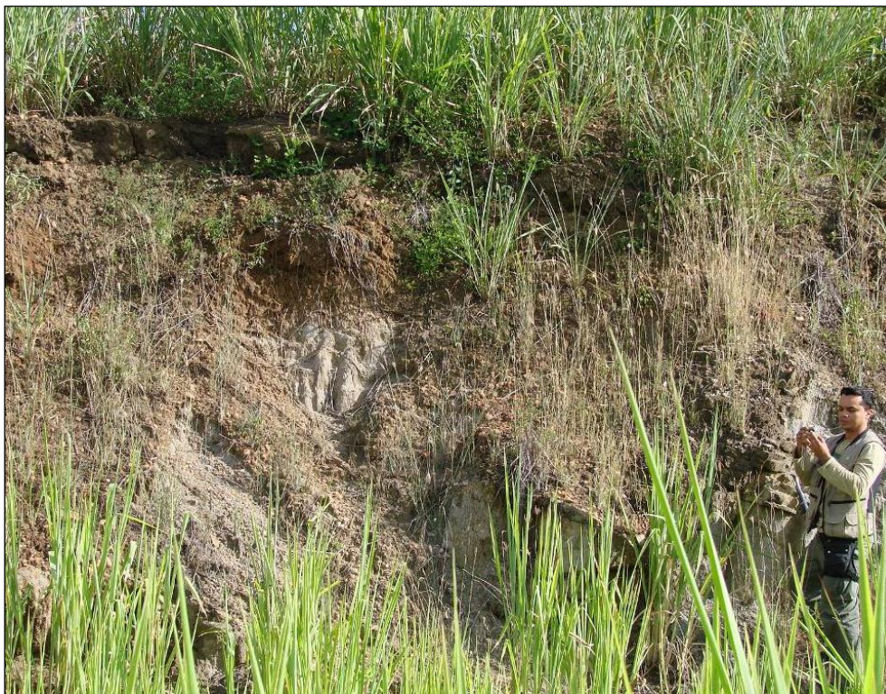
Foto 10.64 - Pequeno desmoronamento de talude junto à rodovia que liga Itambé a Itapetinga - 344.758/8.310.139 - 24L.
