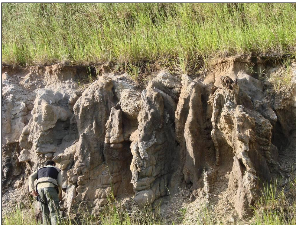
Foto 10.65 - Erosão de talude próximo à entrada da cidade de Itapetinga - 355.973/8.314.447 - 24L.
