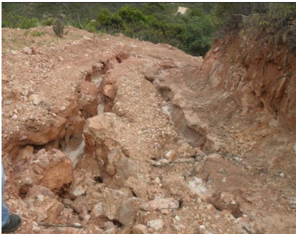
Foto 7.3 - Sulcos erosivos verificados no ponto 2, oriundos da abertura de estradas, os quais foram posteriormente recuperados, após o período de chuvas.
