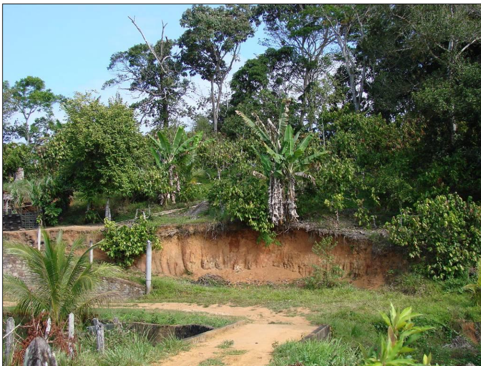
Foto 10.68 - Desmoronamento em talude às margens do rio Sete Voltas em Ilhéus (BA) - 480.860E / 8.376.478N - 24L.
