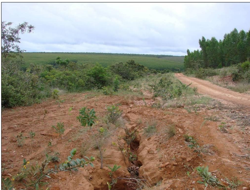
Foto 10.54 - Sulcos e ravina ao lado de estrada vicinal, no trecho inicial do traçado do mineroduto - 737.809/8.201.585 - 23K.
