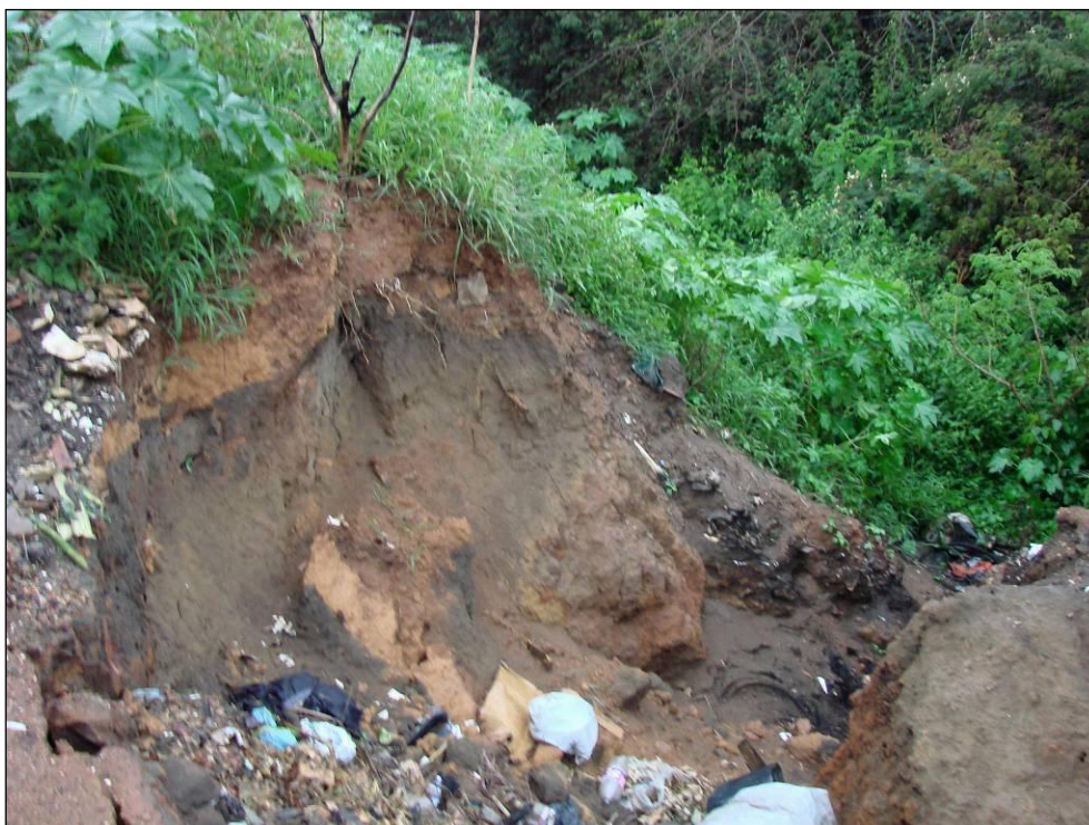
Foto 10.59 - Desmoronamento ao lado da estrada que liga Mirandópolis à rodovia BR-251, no município de Taiobeiras (MG) - 178.185E / 8.244.695N - 24L.
