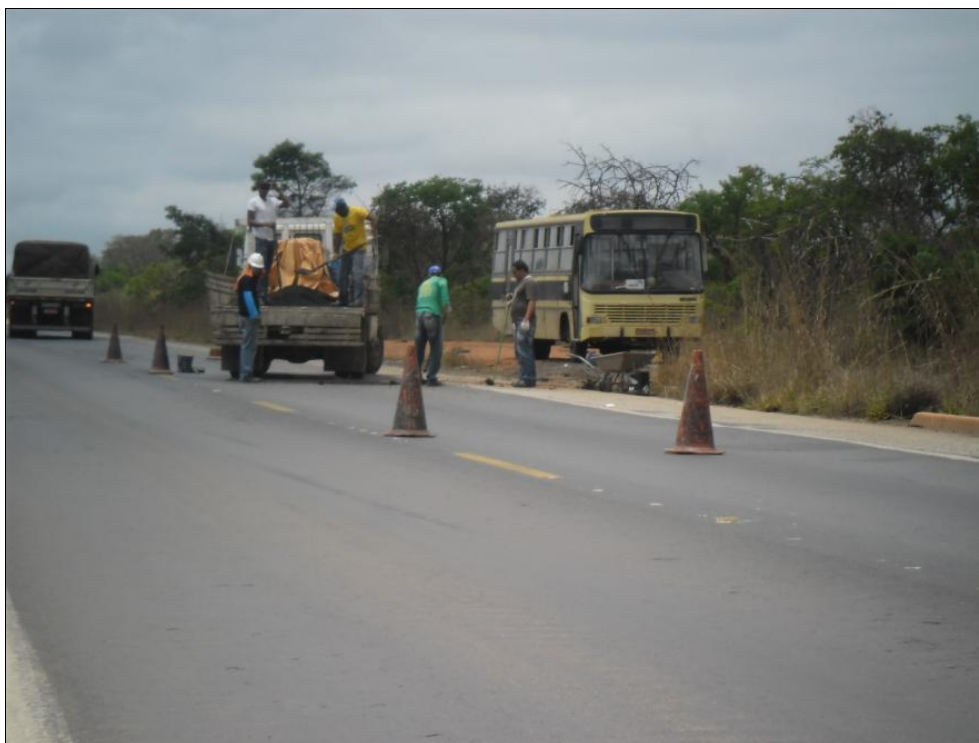
Foto 9.3 - Obras emergenciais para supressão de buracos na BR-251 (Outubro de 2011).
