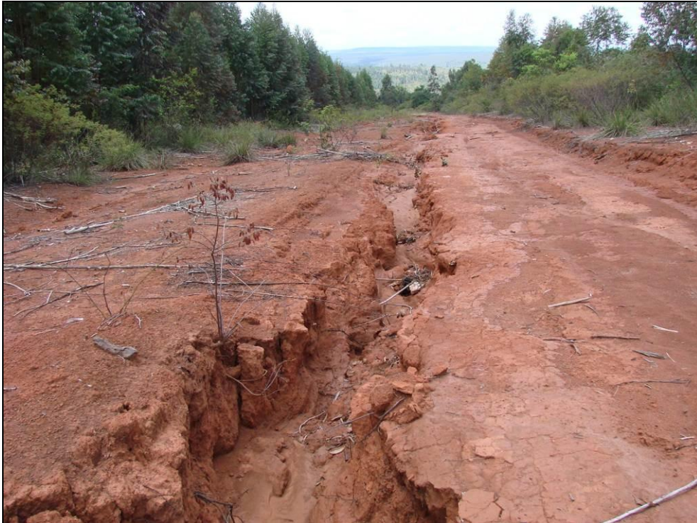
Foto 10.34 - Ravina desenvolvida sobre Latossolo Vermelho (LV), em estrada de acesso de eucaliptal, na área de influência direta da adutora.
