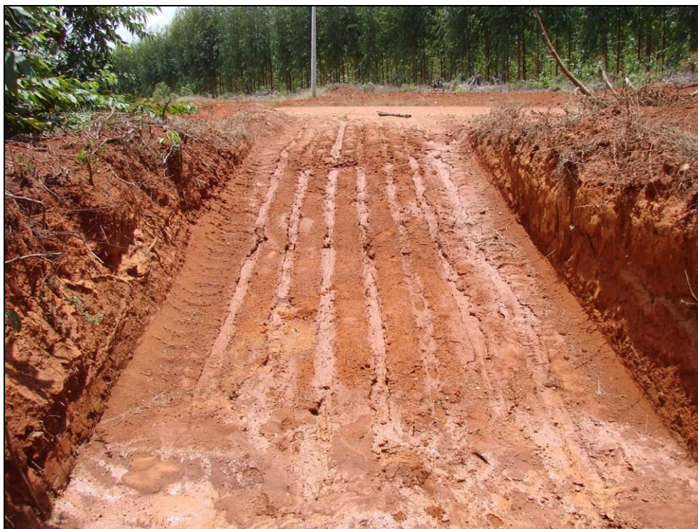
Foto 12.56 - Vala locada na margem de estrada com objetivo de reduzir a velocidade do fluxo superficial.
