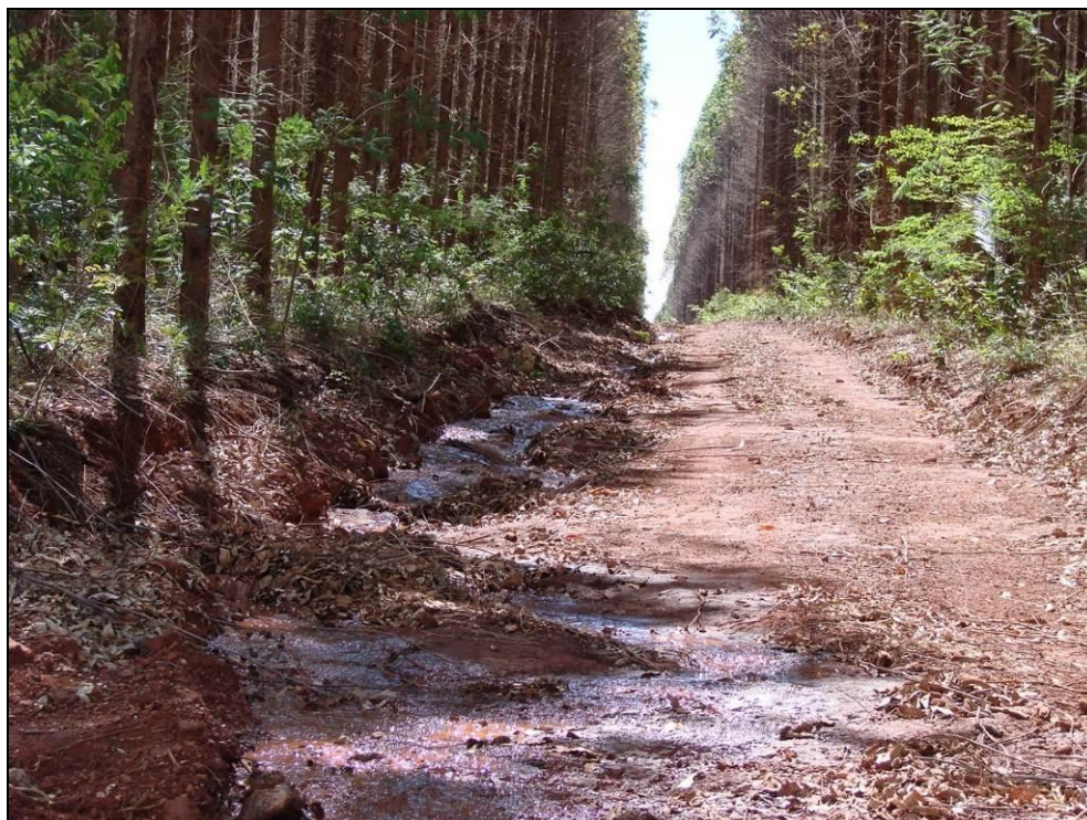
Foto 12.4 - Escoamento da chuva em sulco ao lado de estrada localizada no topo do platô onde se pretende implantar a cava.
