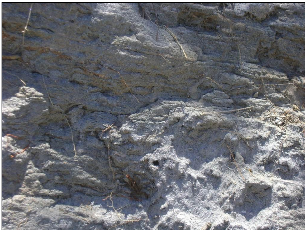
Foto 10.27 - Corte de estrada que evidencia a textura arenosa do Cambissolo Háplico na área da futura cava.
