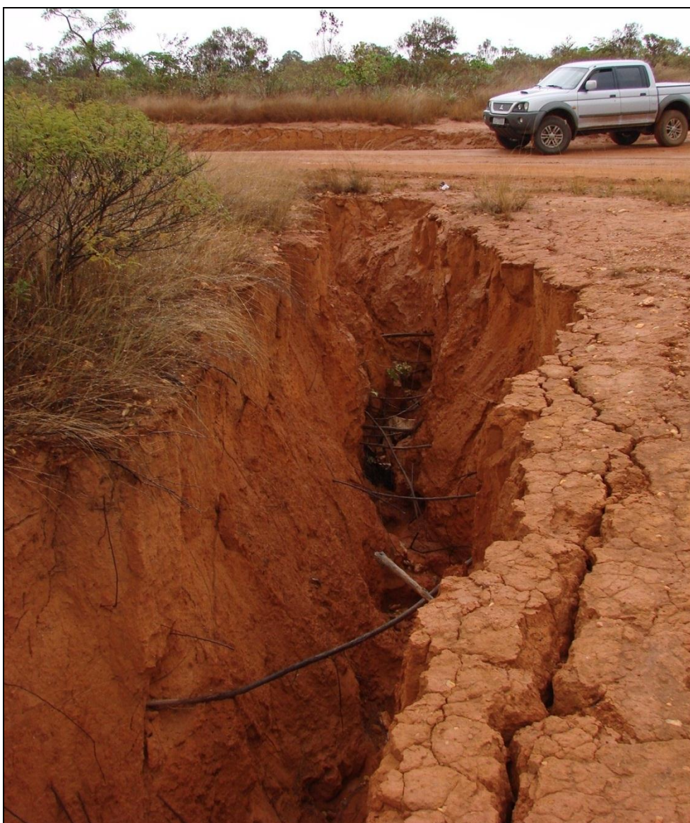
Foto 8.43 - Voçoroca na margem da estrada de Irapé, limite leste da área de estudo.
