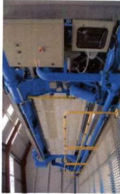
Filtro de Rejeitos
