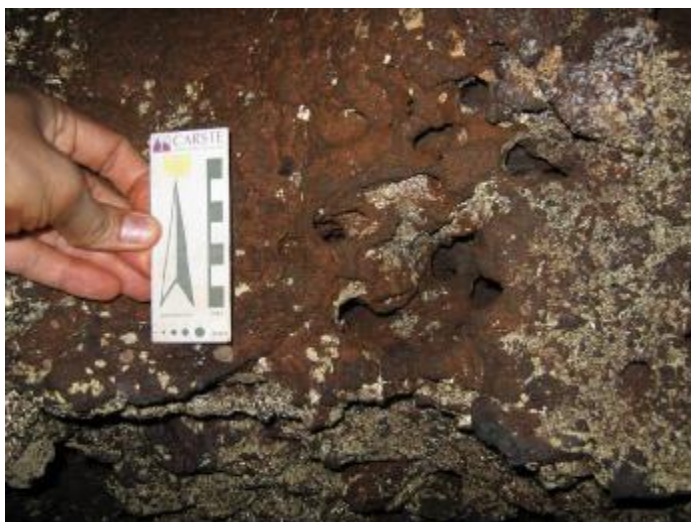
Figura 22. Alvéolos de espessura centimétrica no teto da caverna S11D-71.
