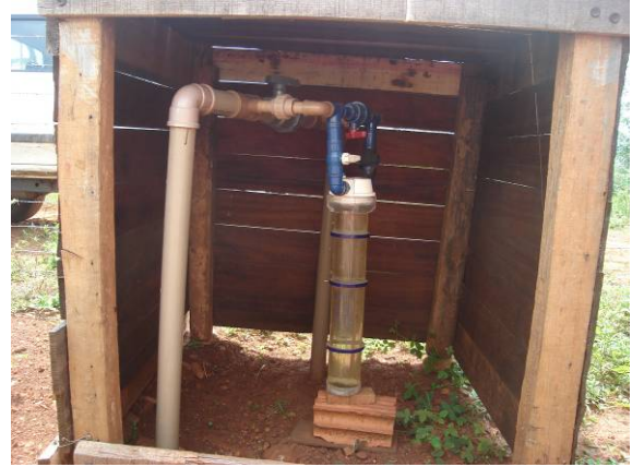
FOTO 02 – Ponto MU-35- dosador de cloro desativado –1ª campanha.
