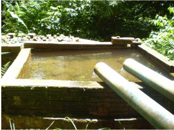
FOTO 12- Caixa de decantação.
