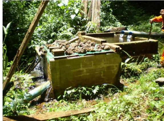
FOTO 13- Caixa de decantação.
