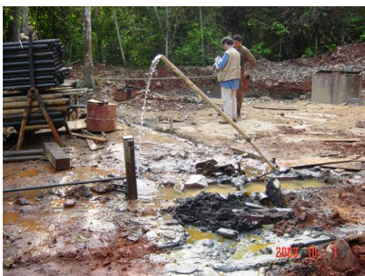
Furo de sondagem jorrante, revestido para monitoramento
