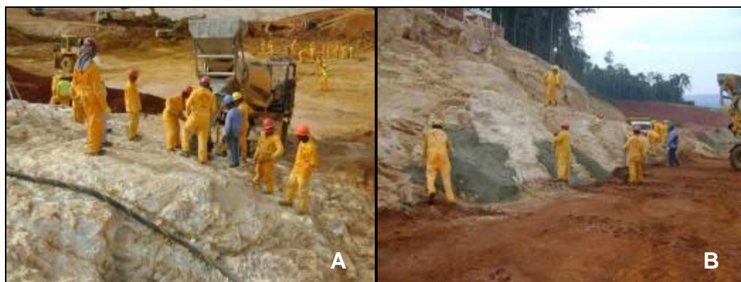
Foto 7-5: (A) Tratamento das cavidades com concreto regularização. (B) Regularização de fendas e fraturas abertas com preenchimento de argamassa.
