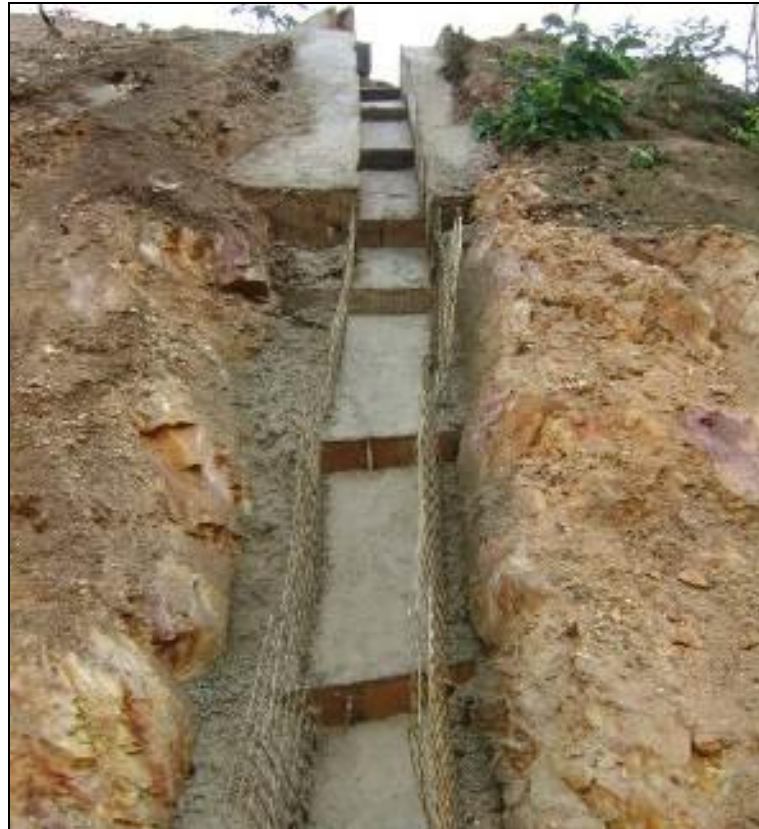
Figura 5-5: Descida de água com degraus inclinados Fonte: RL-9002-X-20024 (BVP, 2012)
