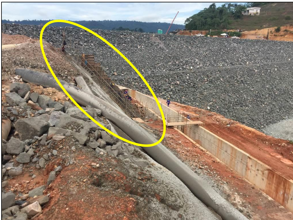
Foto 6-11: Vista para montante do sistema extravasor. Destaque para a escada hidráulica em implantação, que deságua no trecho do extravasor existente
