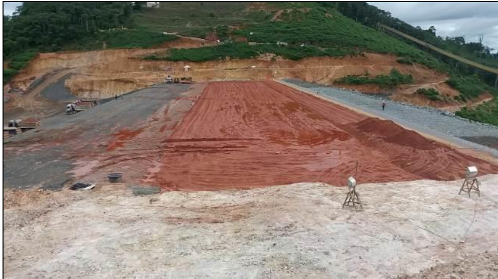
Foto 7-13: Vista da ombreira direita para a esquerda dos maciços com a limpeza já finalizada, EL. 228,40m
