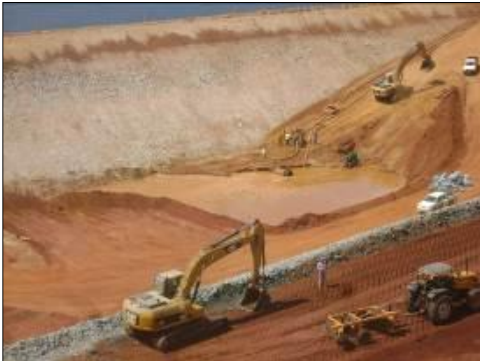
Figura 5-2: Surgência na enseadeira, com acúmulo de água a montante da barragem Fonte: RL-9002-X-20024 (BVP, 2012)
