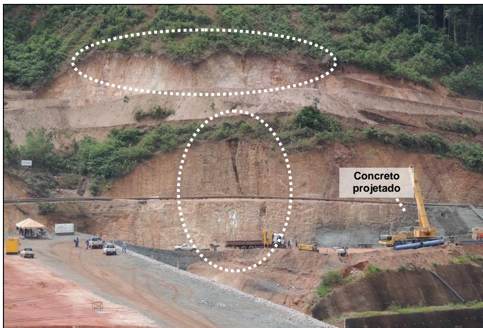
Foto 6-4: Erosões na obreira direita, a montante da barragem
