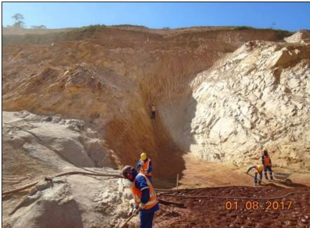
Foto 7-20: Recuo de um dos taludes da fundação da barragem, mostrando o contraste entre a resistência do quartzito e do saprolito de milonito, cujo material mais brando foi removido até a condição de suporte prevista em projeto
