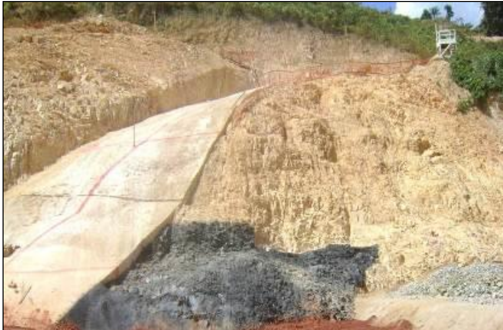
Figura 5-3: Talude verticalizado não atendendo a recomendação de inclinação de projeto Fonte: RL-9002-X-20024 (BVP, 2012)
