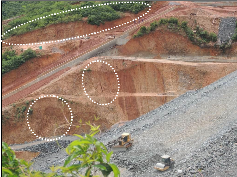
Foto 6-5: Erosões na direção do talude de jusante
