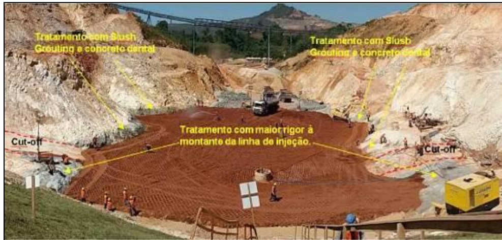
Foto 7-27: Vista montante para jusante dos tratamentos nas ombreiras na região do núcleo, registrado no dia 25/08/17
