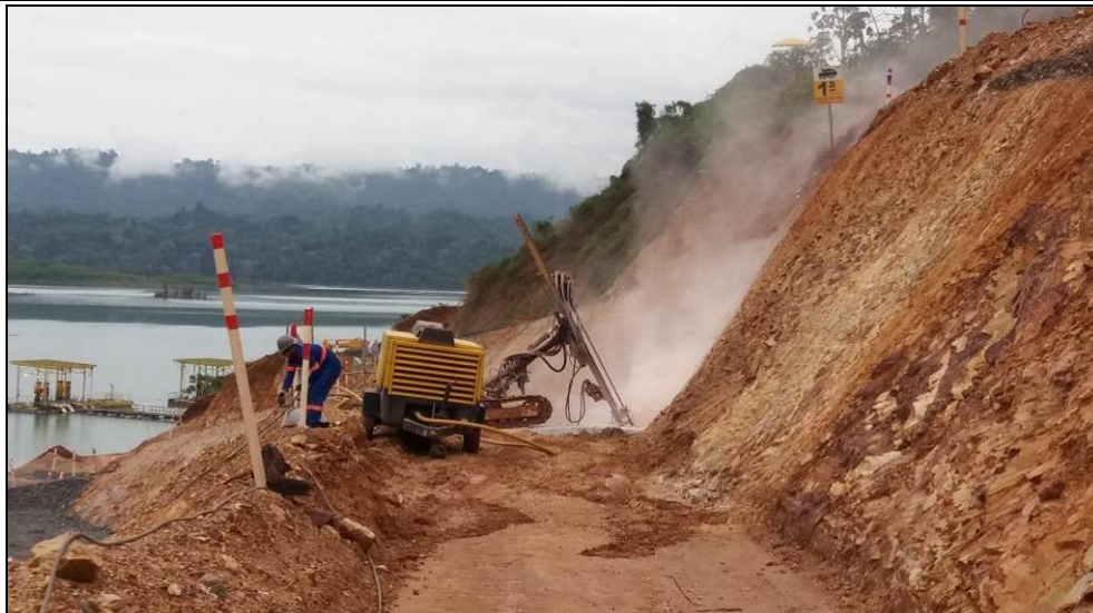
Foto 7-31: Execução de furo para injeção de calda de cimento sob pressão ao longo do eixo da cortina impermeabilizante
