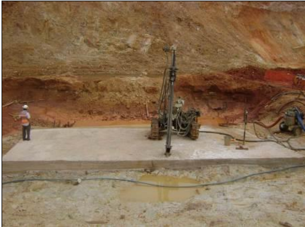
Foto 7-2: Injeções da calda de cimento no maciço rochoso da zona de cut-off , executadas sobre laje de concreto de 0,30 m de espessura.
