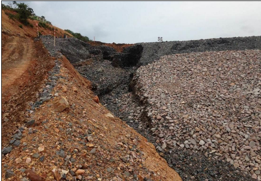
Foto 6-8: Erosão no contato da ombreira esquerda com o espaldar de montante do barramento (Foto do dia 16-10-18)
