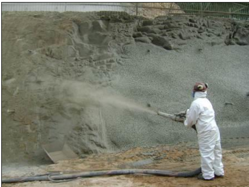
Foto 7-1: Tratamento de concreto projetado com fibras nos maciços rochosos presentes nos taludes de corte do sistema extravasor.
