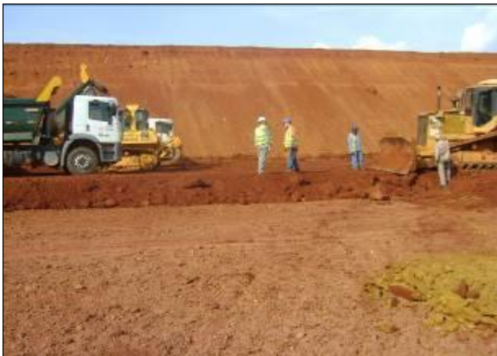
Figura 5-4: Excesso de altura da camada compactada Fonte: RL-9002-X-20024 (BVP, 2012)
