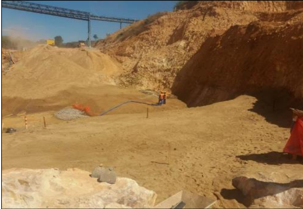
Foto 7-21: Trecho de fundação do aterro de enrocamento recebendo tratamento em areia com objetivo de criar uma transição entre o material de fundação e demais materiais do aterro
