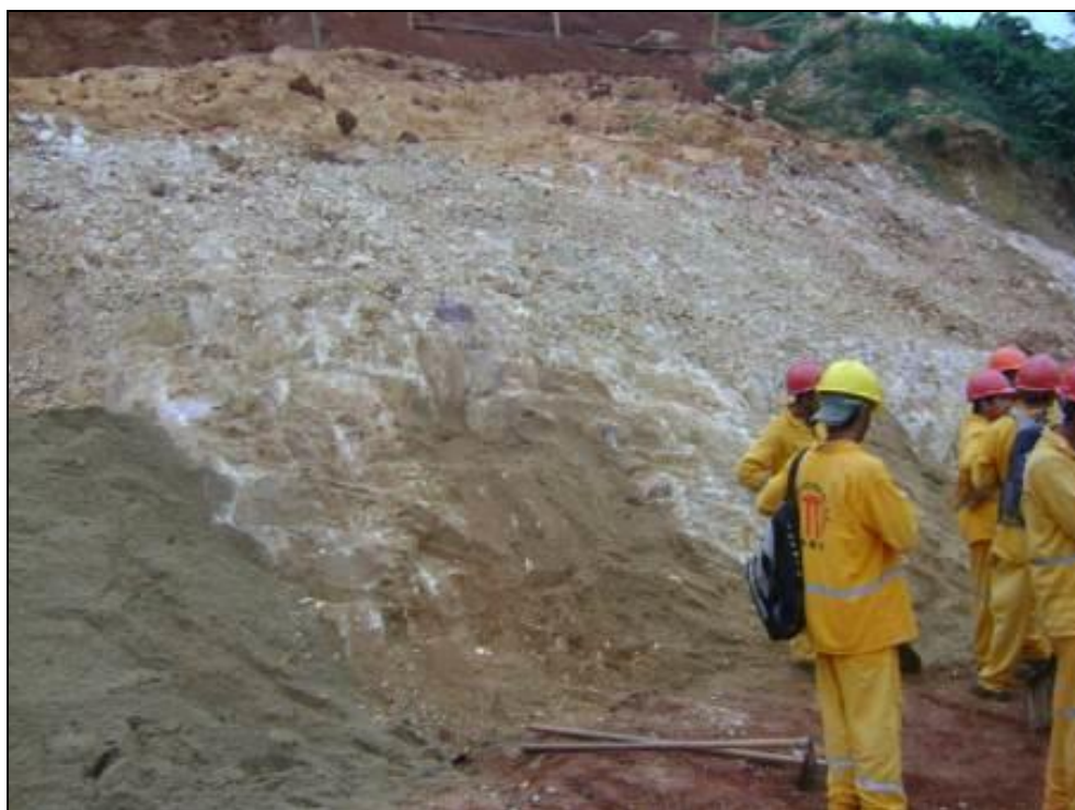
Foto 7-6: Regularização do ângulo de inclinação do maciço rochoso nas ombreiras da região de jusante
