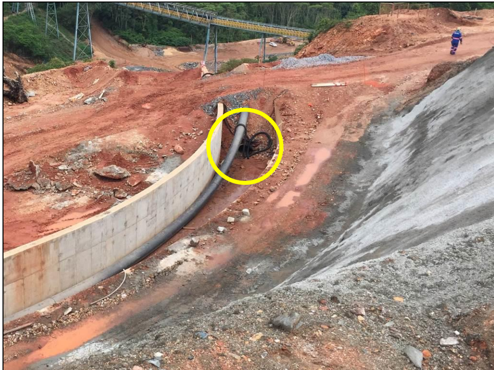
Foto 6-13: Trecho do extravasor existente, obstruído pelo aterro do acesso. Detalhe do tubo implantado, funcionando como bueiro para permitir a passagem de pequenos volumes de água
