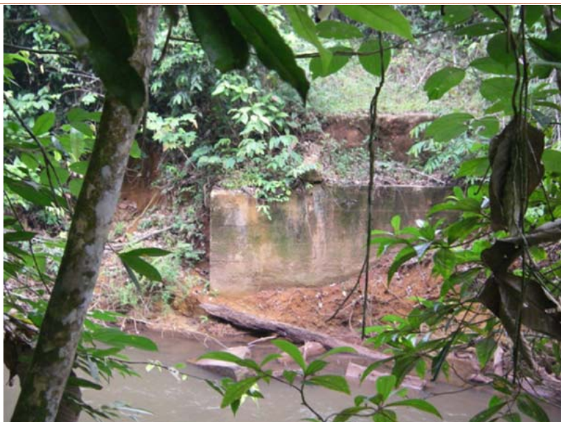
Figura 2 - Ponte deteriorada sobre o rio Águas Claras.
