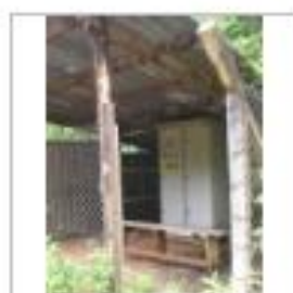
23 - Subestação da galeria.JPG
