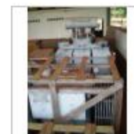
27 - Trafo e Armário Novos - Galeria.JPG
