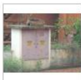
22 - Hidrante - equip combate incêndios.JPG
