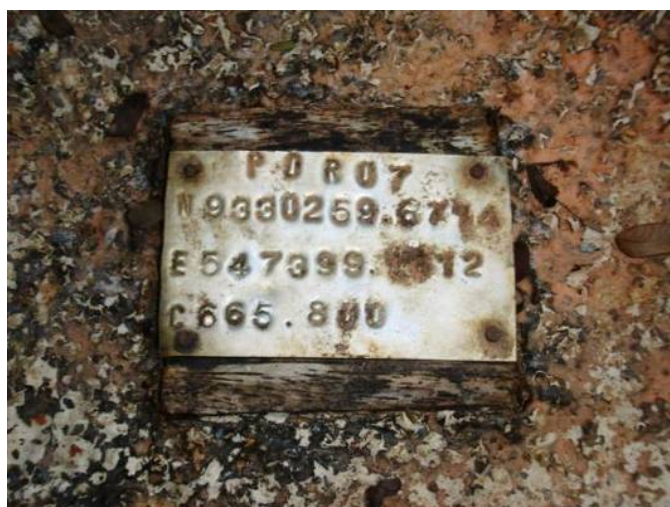
FOTO 02 – Estação de monitoramento PDR 07.
