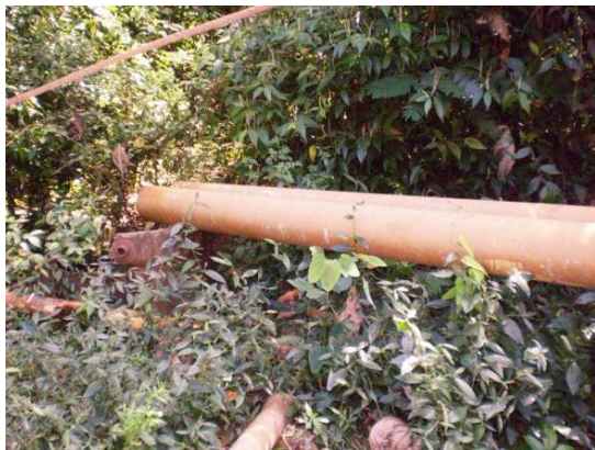
FOTO 01 – Tubulação que transporta a água do poço para o reservatório.
