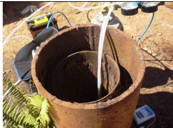
FOTO 03 – Boca do Poço – Estrutura enferrujada - campanha de estiagem.
