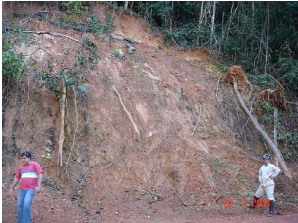
Foto 69 – A- 56 - Escorregamento do talude. composto por material siltoso marrom avermelhado. 50m adiante, arenito fino esbranquiçado a amarelado, medianamente resistente.
