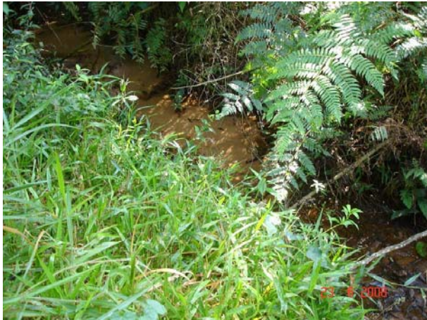
Foto 109 – A- 85 - Estrada interrompida pela drenagem.
