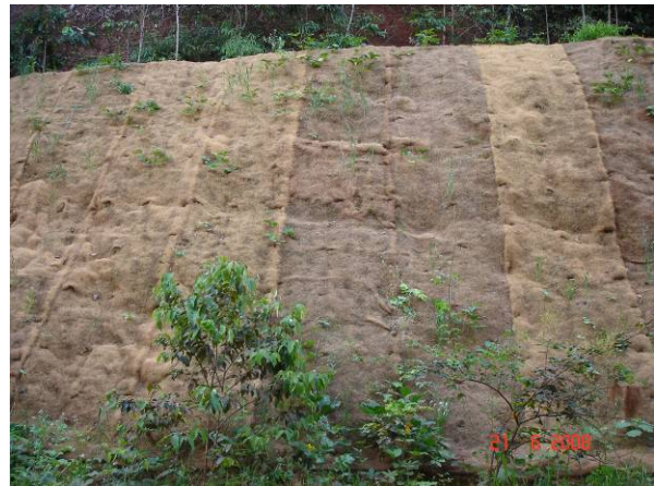
Foto 50 – A- 44 - Talude à esquerda, também recuperado, em arenito friável. Ângulo de face do talude em torno de 55°.
