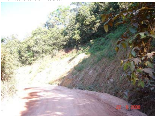
Foto 65 – A- 53 - Talude à esquerda, parte superior (3m) de solo laterítico e parte inferior (6m) de arenito friável (Sn: 095°/20°; 050°/20°).
