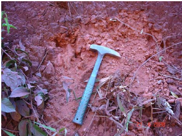
Foto 57 – A- 48 - Talude à direita, de 6m de altura, solo laterítico com fragmentos cm a dm.
