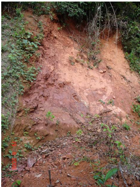
Foto 07 – A-04 - Escorregamento. Mesma rocha do ponto anterior.
