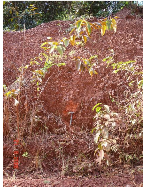
Foto 54 – A- 47 - Talude à esquerda, de 4m de altura, de um solo laterítico com fragmentos cm.
