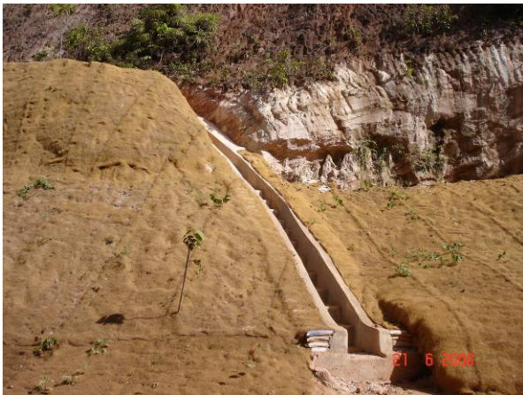
Foto 49 – A- 43 - Talude à direita em arenito friável de coloração esbranquiçada (Sn: 125°/15°; 155°/25°), com cerca de 20m de altura, parcialmente recuperado.
