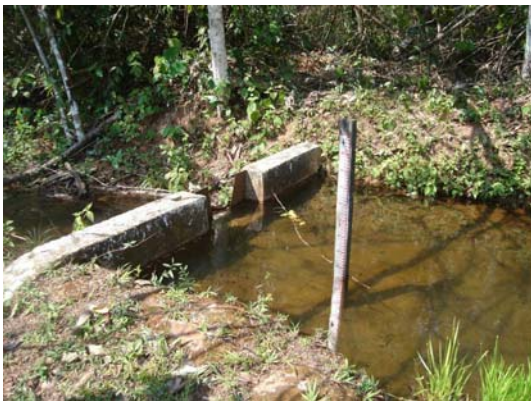
FOTO 29 – Vertedouro de monitoramento fluviométrico VT-04 que monitora as vazões a jusante dos tubos de transpasse da barragem de água. (GOLDER, setembro de 2008).
