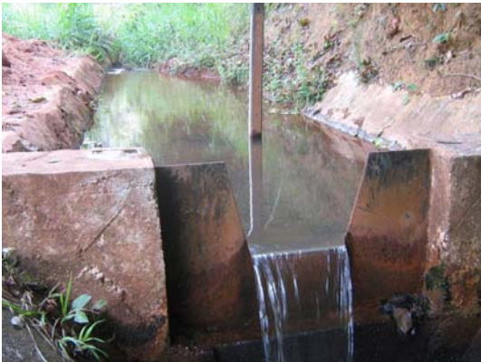
FOTO 21 – Vertedouro de monitoramento fluviométrico VT-01 – Igarapé Alemão. (GOLDER, setembro de 2008).
