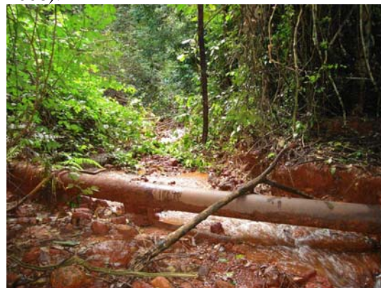
FOTO 36 – Leito do igarapé Vizinho, que recebe as vazões vertidas das cavas Furo 30 e Acampamento Sul. Detalhe da adutora de recalque de água da barragem para a planta industrial da Mina Igarapé Bahia. (GOLDER, maio de 2008).
