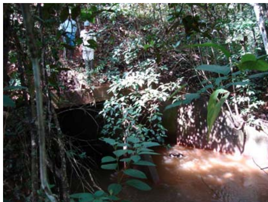
FOTO 14 – Ribeirão Águas Claras - Vista de jusante para montante do bueiro de travessia da estrada de acesso ao Projeto Alemão. (GOLDER, maio de 2008).
