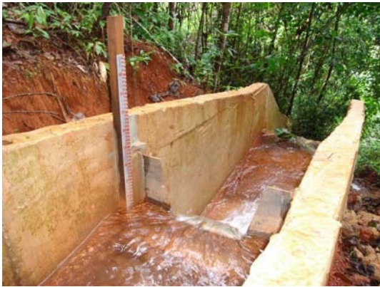
FOTO 33 – Vertedouro de monitoramento fluviométrico VT-09 que monitora as vazões vertidas da Cava Acampamento Sul. (GOLDER, maio de 2008).
