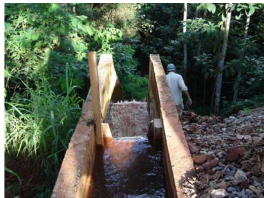
FOTO 24 – Vertedouro de monitoramento fluviométrico VT-10 que monitora as vazões vertidas da Cava Furo 30. (GOLDER, maio de 2008).
