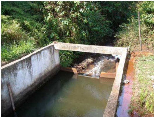
FOTO 27 – Vertedouro de monitoramento fluviométrico VT-06 instalado no final da bacia de dissipação do vertedouro da barragem de água para monitorar as vazões defluentes. (GOLDER, setembro de 2008).
