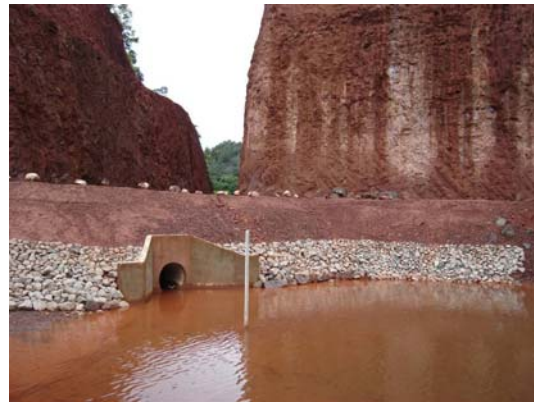
FOTO 32 – Sistema extravasor da Cava Acampamento Sul composto por ala de emboque e bueiro circular simples. (GOLDER, maio de 2008).
