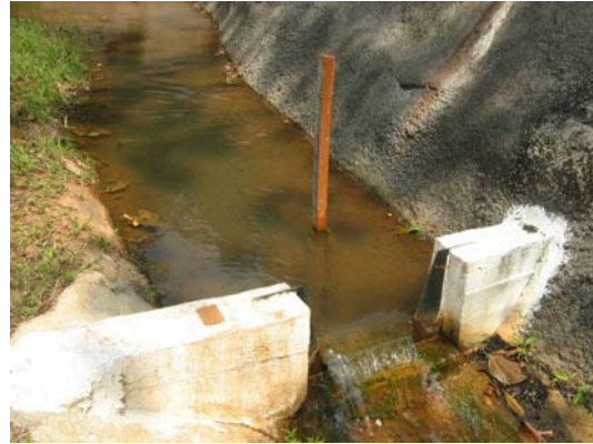
FOTO 20 – Vertedouro de monitoramento fluviométrico VT-08 – Monitora a vazão que sai da galeria de pesquisa. (GOLDER, setembro de 2008).
