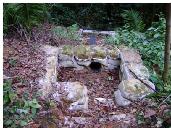
Figura 41: Erosão antrópica – caixa dissipadora
