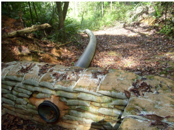
Figura 36: Erosão natural – caixa dissipadora leste
