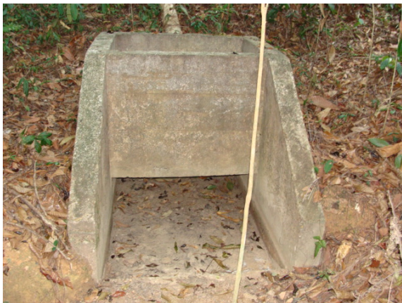
Figura 7: Dissipador de energia
