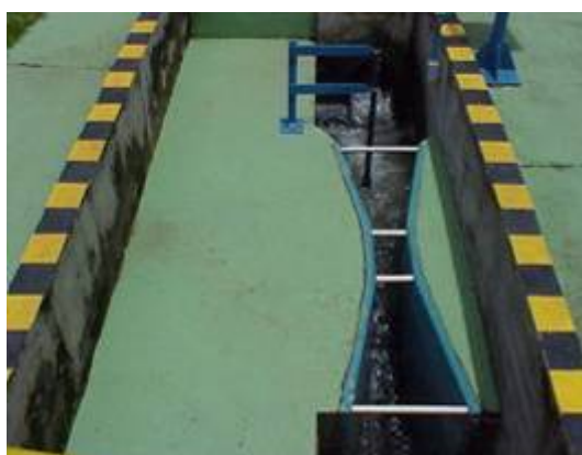
Figura 516: Calha Parshall (medidor de vazão)
