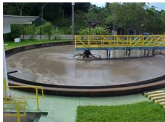
Figura 519: Tanque de decantação
