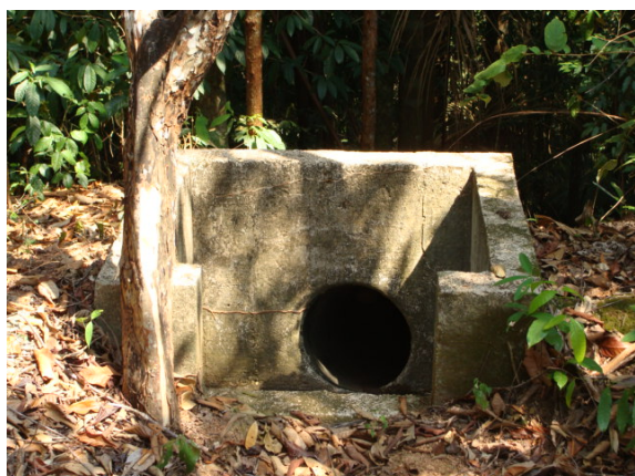
Figura 16: Caixa de drenagem
