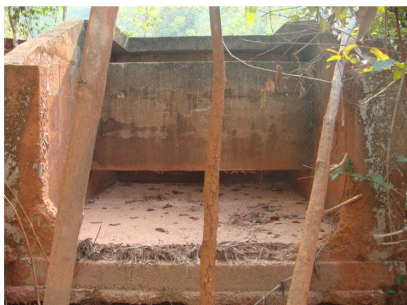
Figura 12: Dissipador de energia
