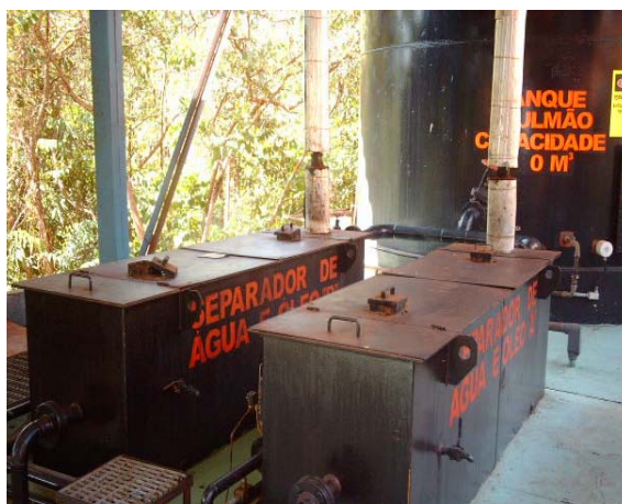
Figura 515: Separadores de água e óleo da UGI
