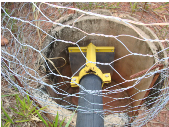
Figura 24: Caixa de drenagem
