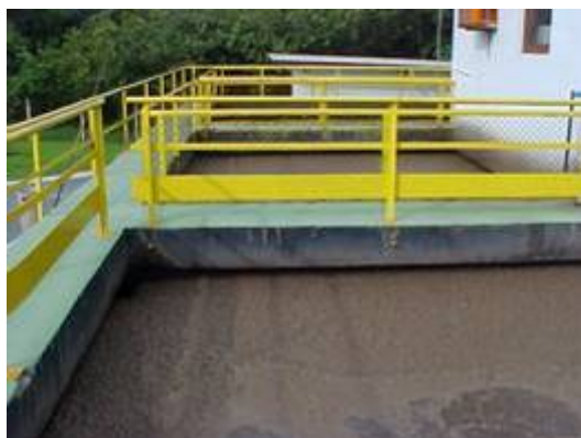
Figura 518: Tanques de aeração (processo aeróbio)
