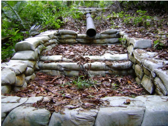
Figura 42: Erosão antrópica – caixa dissipadora
