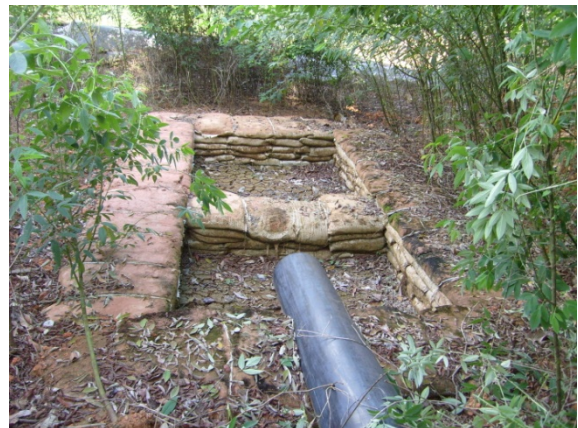
Figura 37: Erosão natural – caixa dissipadora oeste
