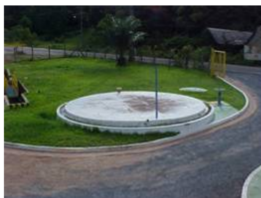
Figura 517: Tanques Imhoff (processo anaeróbio)
