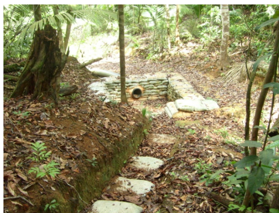
Figura 35: Erosão natural – caixa dissipadora leste
