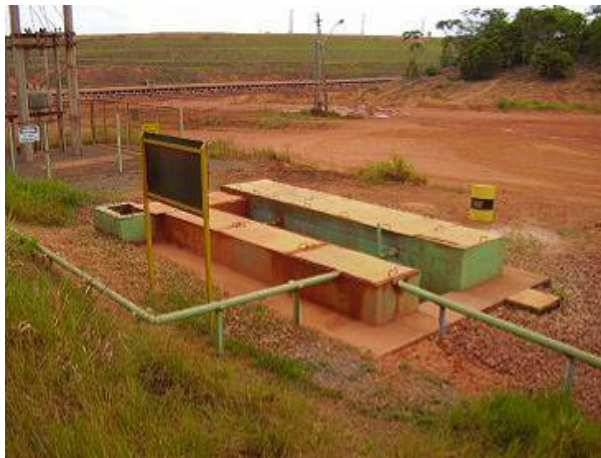
Figura 514: Separador de água e óleo da oficina e posto de abastecimento SA 3
