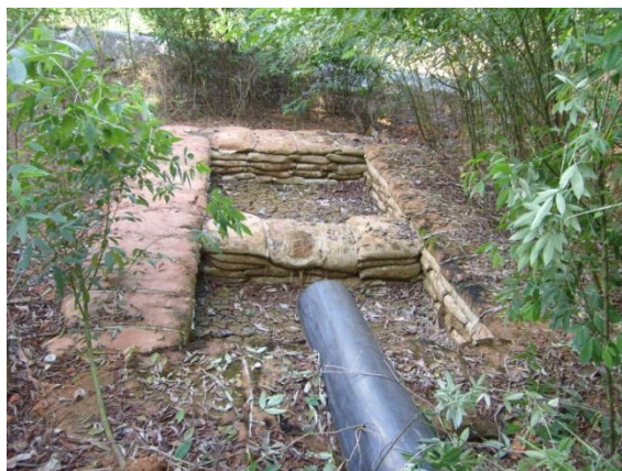
Figura 59: Erosão natural – caixa dissipadora oeste
