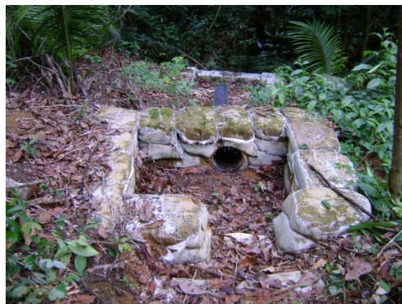
Figura 63: Erosão antrópica – caixa dissipadora
