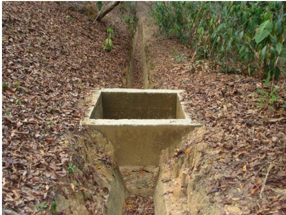
Figura 27: Caixa de drenagem e canaleta
