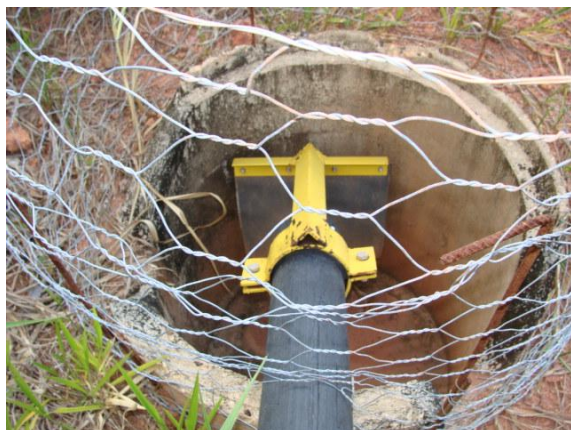
Figura 46: Caixa de drenagem
