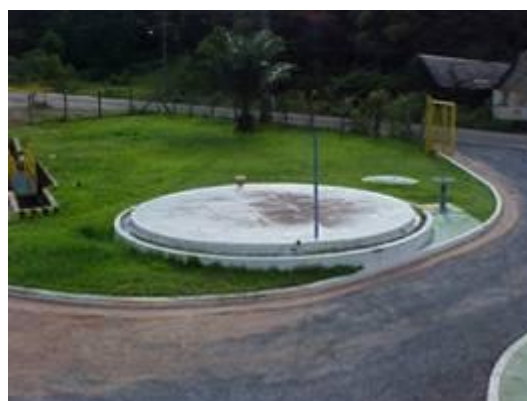
Figura 1059: Tanques Imhoff (processo anaeróbico)
