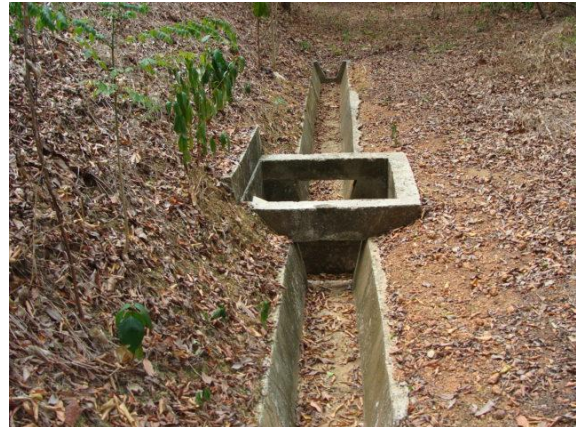
Figura 28: Caixa de drenagem e canaleta
