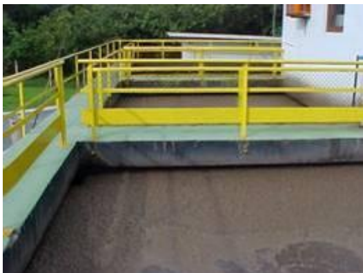
Figura 1060: Tanques de aeração (processo aeróbio)
