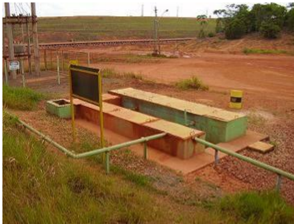
Figura 1056: Separador de água e óleo da oficina e posto de abastecimento SA 3
