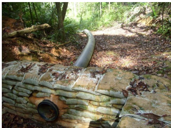
Figura 58: Erosão natural – caixa dissipadora leste
