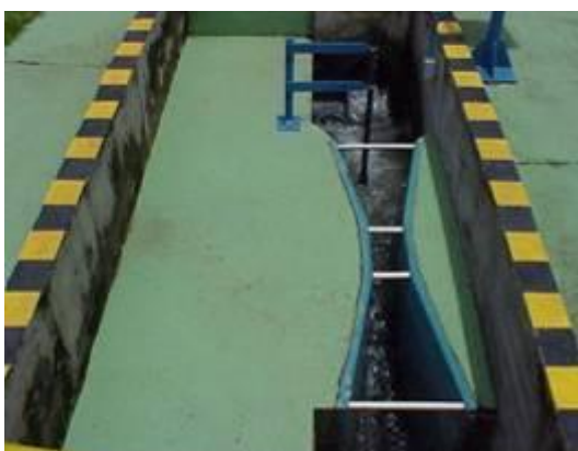
Figura 1058: Calha Parshall (medidor de vazão)
