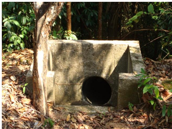
Figura 38: Caixa de drenagem
