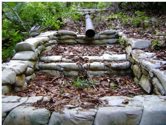
Figura 64: Erosão antrópica – caixa dissipadora
