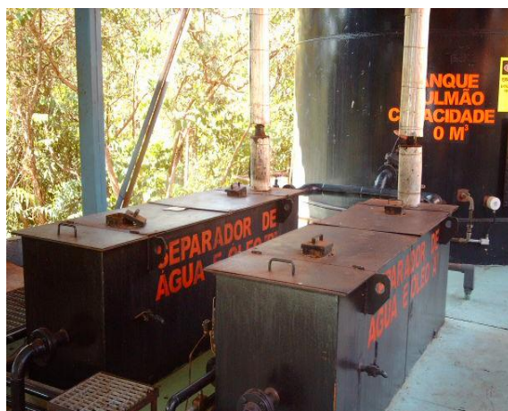
Figura 1057: Separadores de água e óleo da UGI
