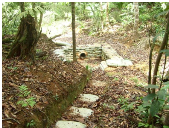
Figura 57: Erosão natural – caixa dissipadora leste
