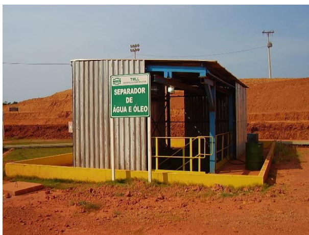
Figura 1055: Separador de água e óleo do posto de abastecimento e oficina de lubrificação do platô Aviso
