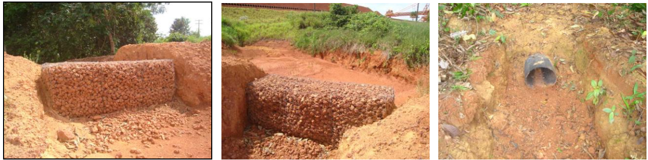
SA 16(E 0564750 / N 9814563) - Coordenada do ponto do filtro gabião Tubulação com filtro na captação de água e dissipador de energia na ponta inferior.
