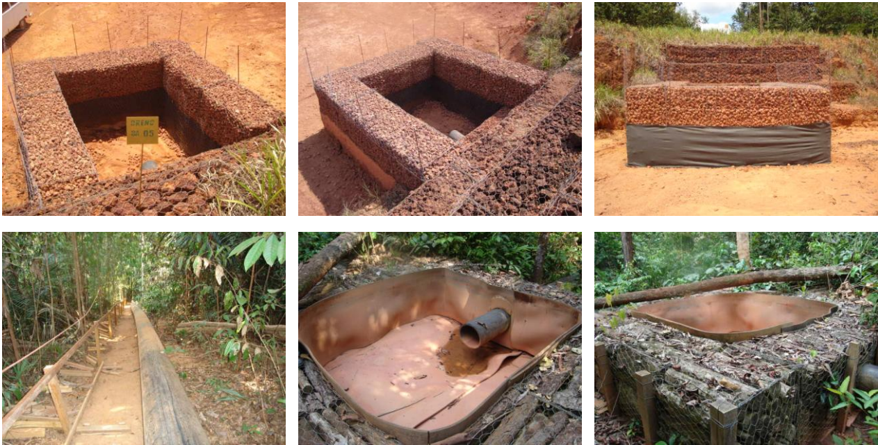
SA 05 (E 0559271 / N 9815408) – Coordenada do ponto do filtro gabião Tubulação com filtro na captação de água e dissipador de energia na ponta inferior.
