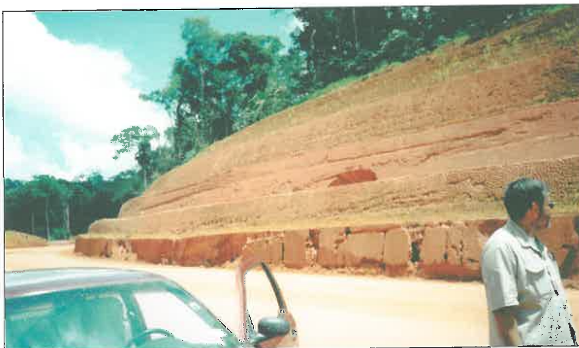
FOTO 11 - Exemplo de processos de erosão que podem ocorrer nas estradas de acesso (estrada entre a Mina e o Britador do Papagaio).
