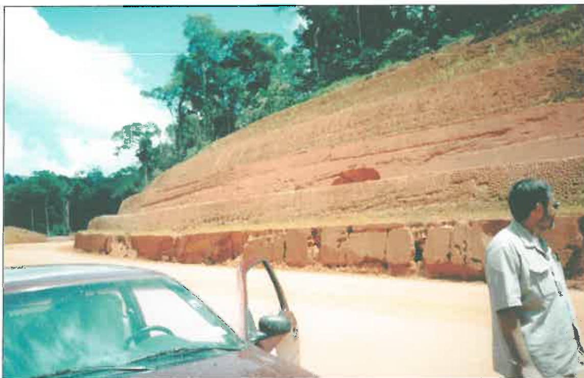
FOTO 11 - Exemplo de processos de erosão que podem ocorrer nas estradas de acesso (estrada entre a Mina e o Britador do Papagaio).
