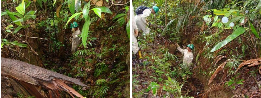
Figura 15 - Fotos da Erosão 5: Coordenada UTM N 9822860 E 0547078
