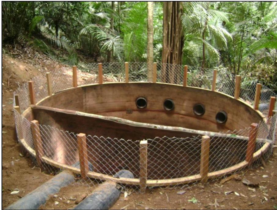
Figura 24 – Caixa dissipadora instalada.
