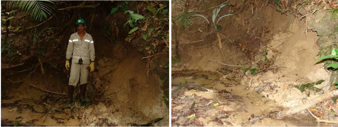
Figura 12 - Fotos da Erosão 2: Coordenada UTM N 9817784 E 0551719
