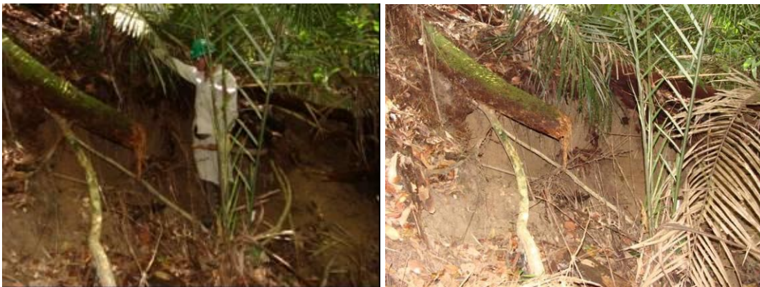
Figura 11 - Fotos da Erosão 1: Coordenada UTM N 9816827 E 0550093
