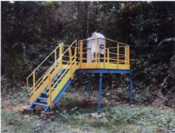
Figura 8 - Equipamentos de controle de ar e ruído
