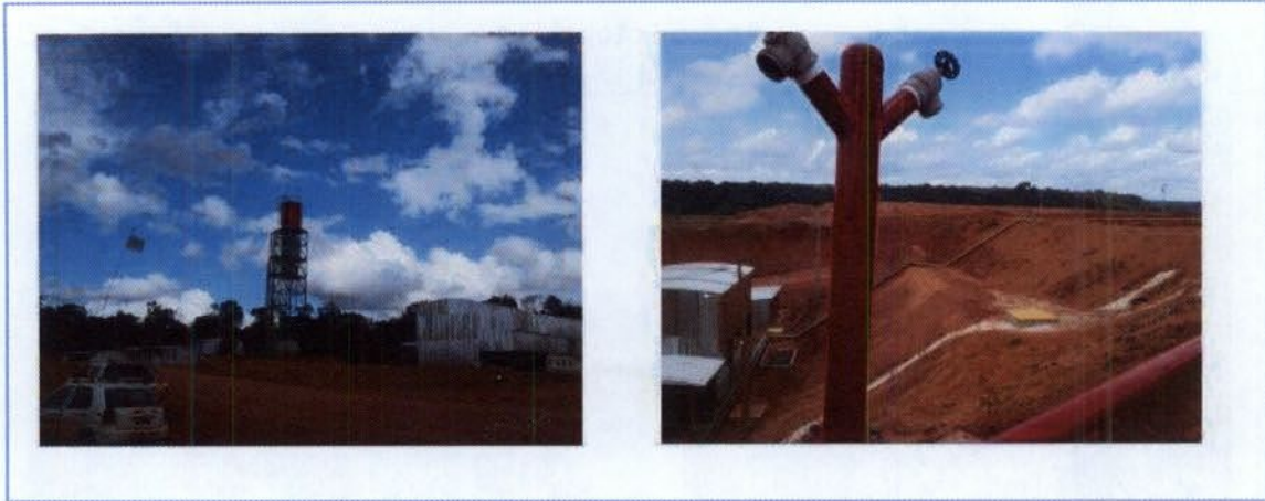
Figura 3 - Sistema de Combate à Incêndio
