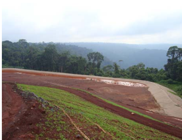
Figura 38: Implantação de diques de amortecimento: todas as drenagens periféricas são direcionadas para estes diques que possuem a função de sedimentar as partículas sólidas da enxurrada e drenar a água de forma disciplinada.
