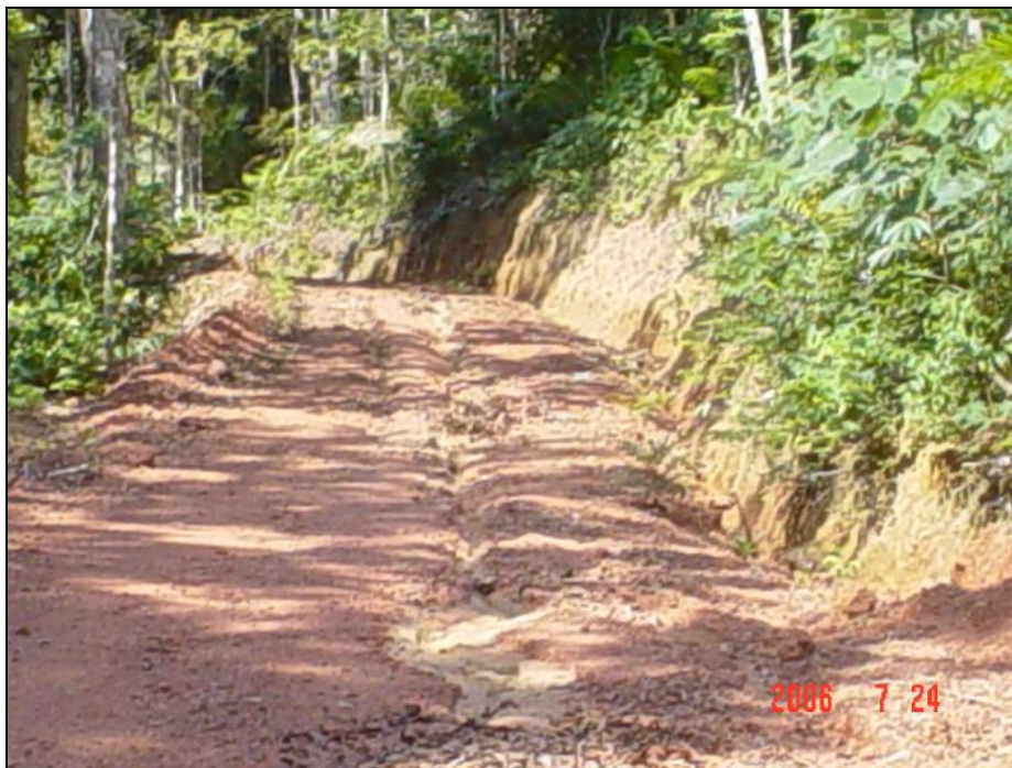
Foto 4 - Acesso com sulcos erosivos formados pelo escoamento superficial pluvial concentrado (coordenadas UTM 0551066; 9804340).
