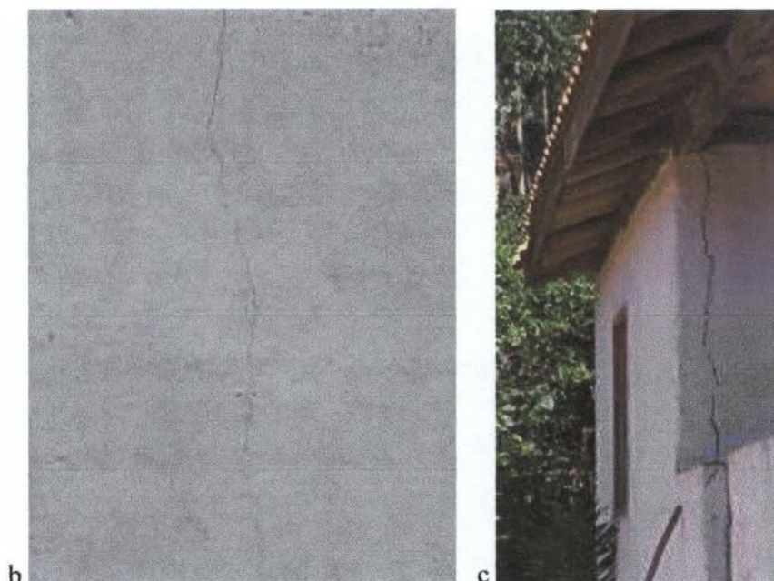
Figura 1- a) Linha branca representa a faixa de Servidão, observa-se que ela distancia-se menos de 5 metros da casa do parceiro, ao fundo observa-se o cafezal. b,c) Destaque para as rachaduras que a casa já apresenta. Fonte: NACAB, 2012.
