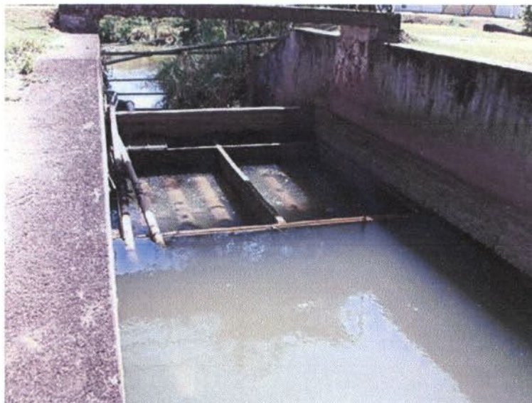
Figura 8 – Detalhe da estrutura de captação (tubulações submersas perfuradas) de água da ETA UFV com nível de água crítico em período de estiagem.
