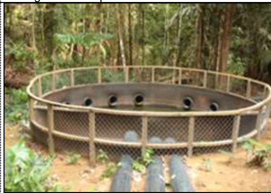
Caixa dissipadora de energia
