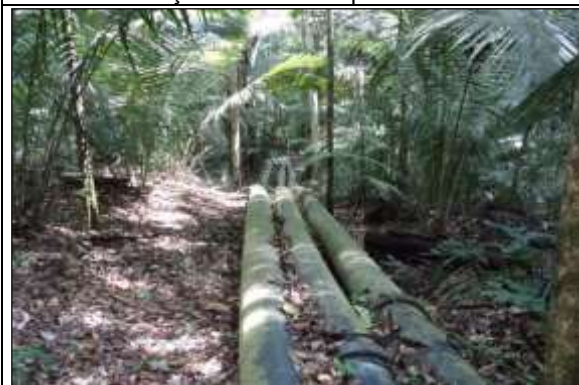
Tubulação de drenagem
