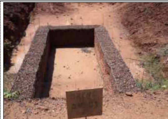
Filtro gabião com placa indicativa do Dreno AV 01
