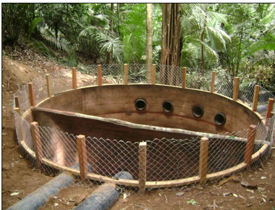
Figura 15 – Caixa dissipadora instalada.
