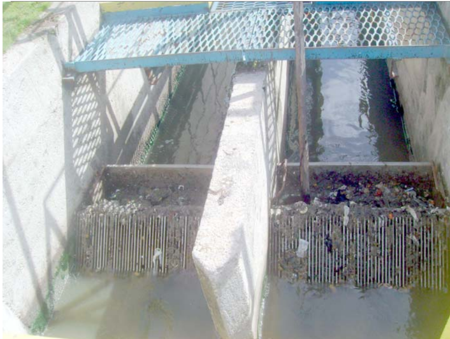
Foto 13: Caixa de Contenção de Resíduos Sólidos
