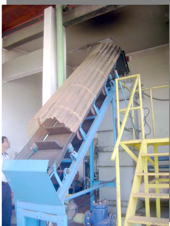
Foto 12: Incinerador de Resíduo Hospitalar
