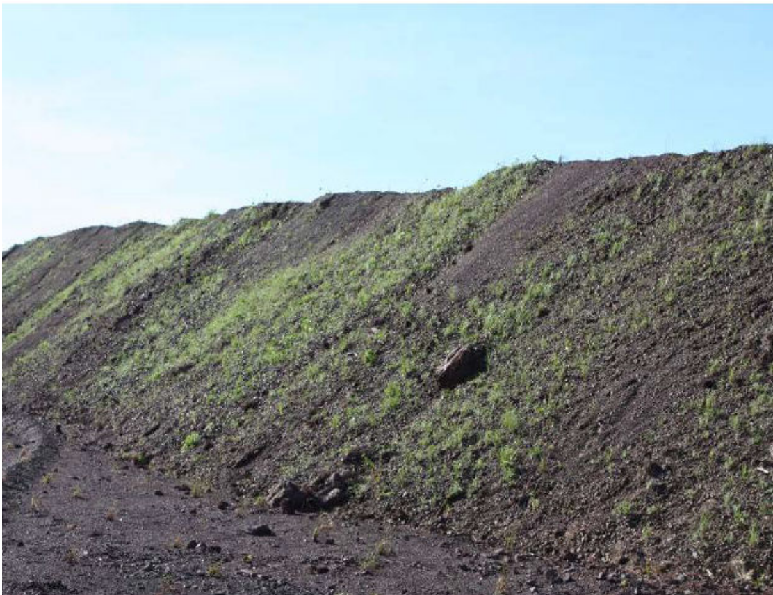
Figura 8.2.1.10-10: Talude recuperado exclusivamente com a utilização de topsoil (foto tirada após seis meses da utilização do mesmo).
