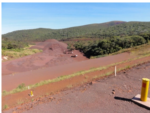
Figura 4.1.6.2.1-6. Vista a jusante da barragem de rejeitos, verificando-se um dos pátios de armazenagem da mina.
