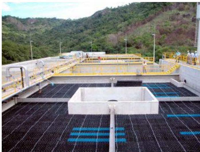
Figura 6.3-3: Estação de tratamento de esgoto do Vale do Mulembá.
