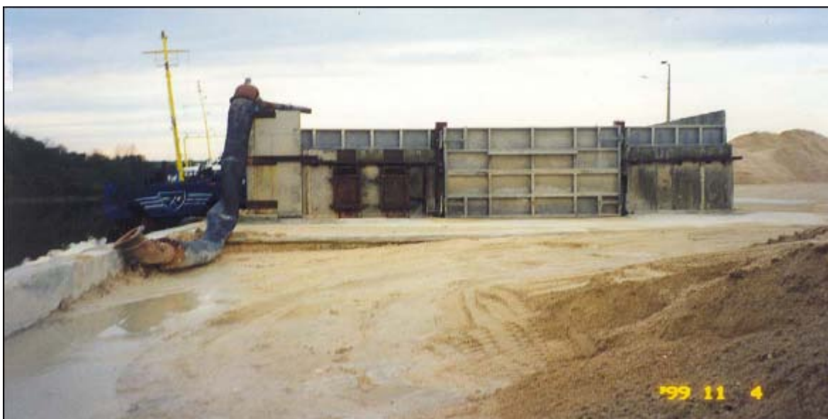
Figura 4.4-16: Exemplo de caixa de decantação para descarregamento hidráulico de sedimento biodetrítico marinho na Bretanha – França.
