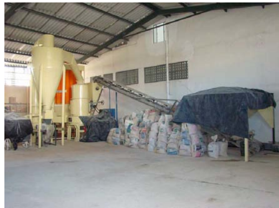
Figura 4.5-2: Unidade de beneficiamento da Algadermis. Visão geral do moinho
