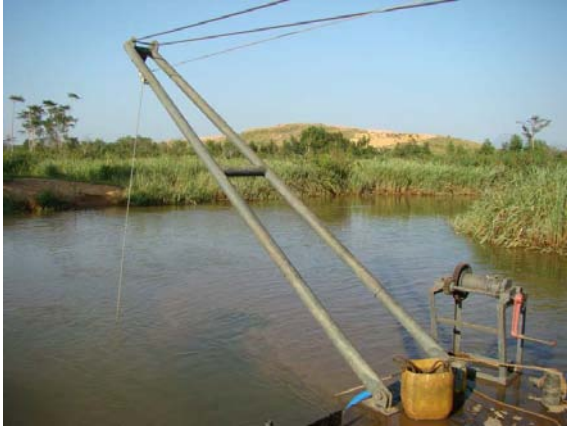
Figura 4.4-13: Braço e guincho para sustentação da tubulação de dragagem.
