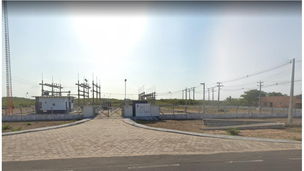
Figura 63. Subestação de Barro Duro. Fonte: Google Maps, 2020
