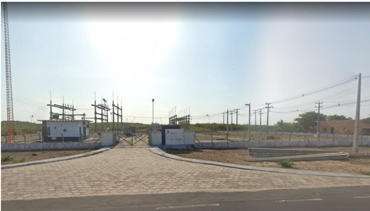
Figura 4.6.3.10-1: Subestação de Barro Duro. Fonte: Google Maps, 2020.
