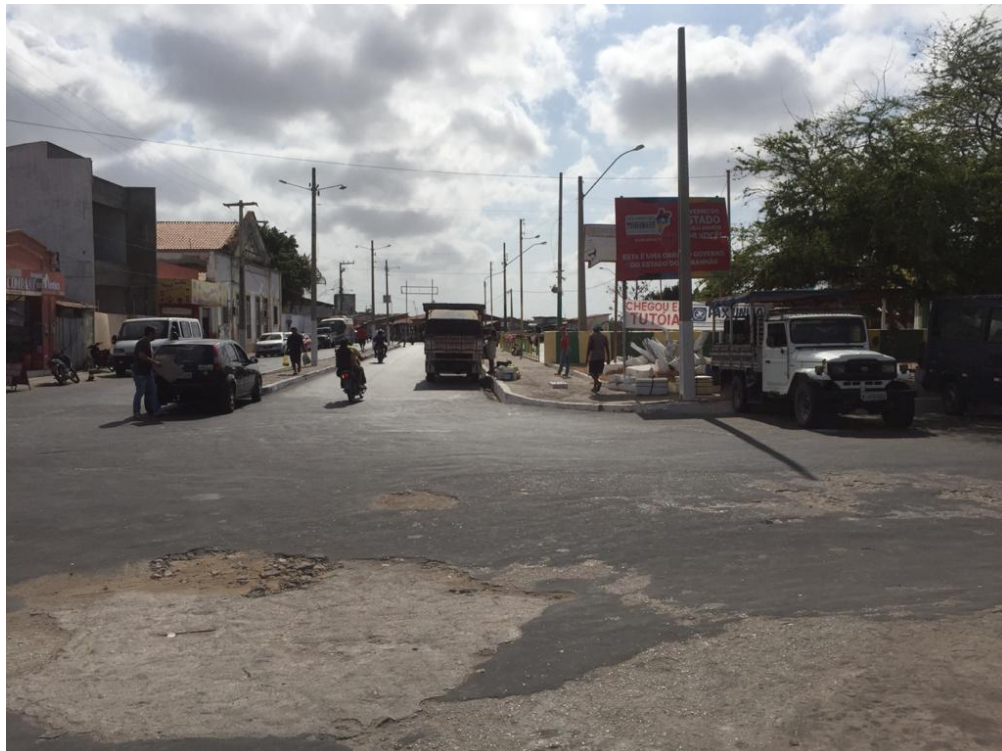
Figura 5.3.11.1-8: Condições do asfalto. Fonte: DPG Consultoria, 2018.
