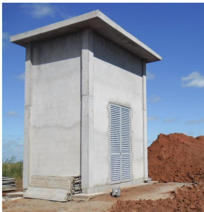
Figura 9.16 - Casa de chaveamento toda em concreto com porta de aço para evitar vandalismo
