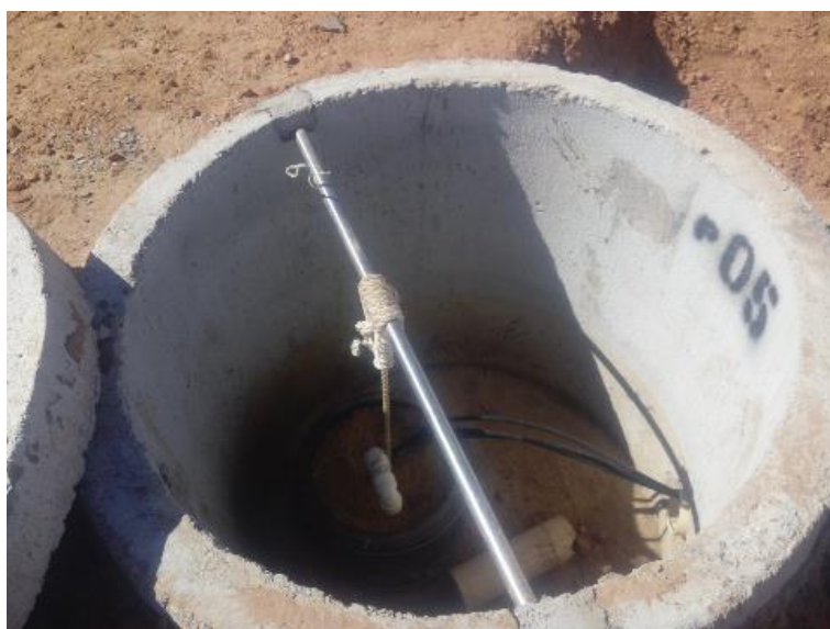
Figura 9.11 - Acabamento do Poço e barramento de interligação de anodos.
