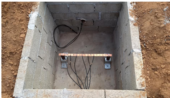
Figura 9.13 - Acabamento do Poço e barramento de interligação de anodos.
