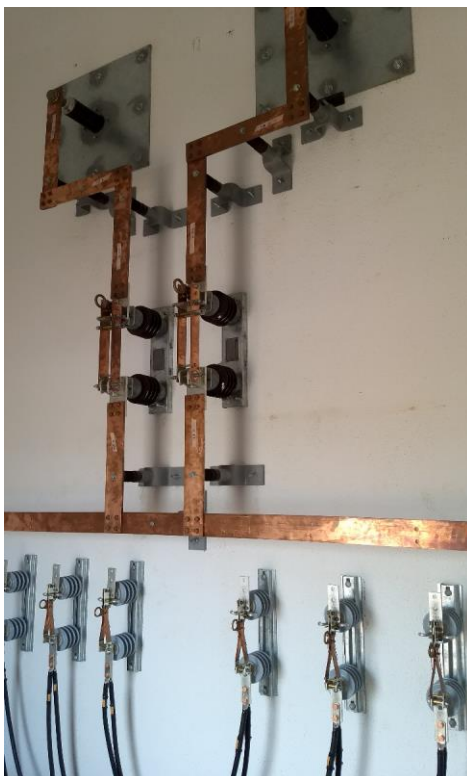
Figura 9.17 - Barramento Central de Transição do Eletrodo com a LT.
