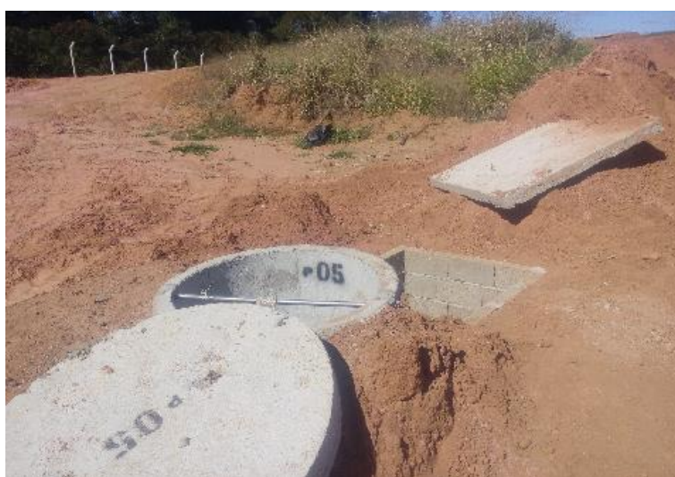
Figura 9.12 - Acabamento do Poço e barramento de interligação de anodos.
