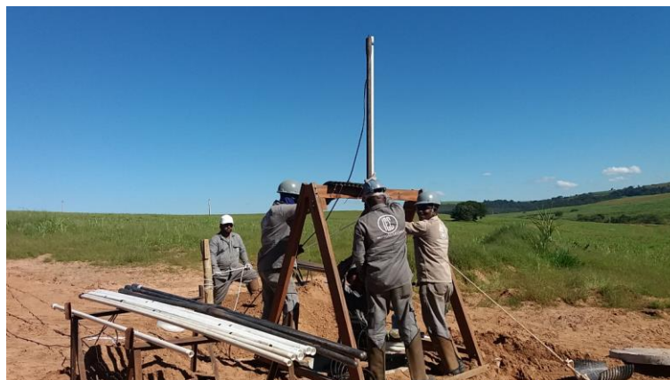
Figura 4.8 – Instalação de tubulação de retorno de gases.
