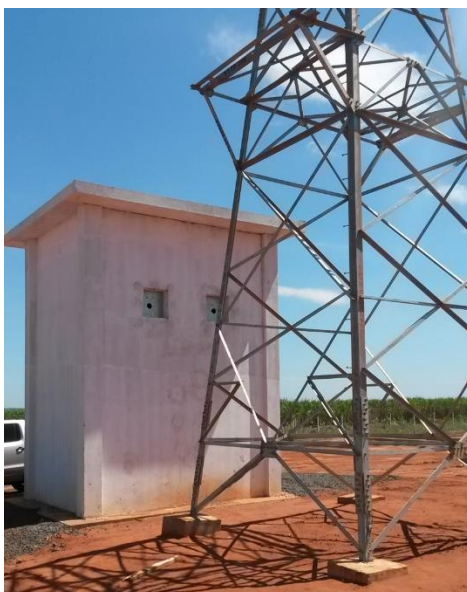
Figura 9.18 - Casa de chaveamento próxima a torre da LT (vista das janelas das buchas)
