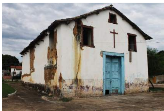
Figura 6.5.2-166 - Igreja Matriz Nossa Senhora de Santana, fachada. Acervo: Scientia Consultoria Científica: Thiago Guerra, 24.11.2015.
