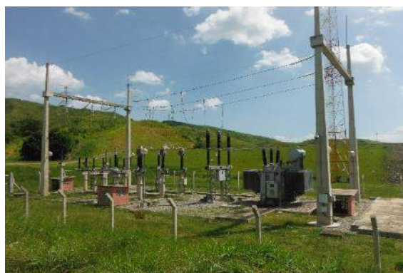
Figura 6.4.9-208 – Subestação da PCH Paracambi no Ribeirão das Lages. Município de Paracambi, RJ.
