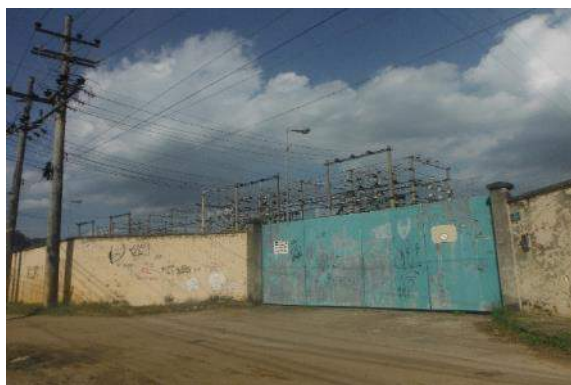
Figura 6.4.9-215 – Subestação no bairro São Miguel. Município de Seropédica, RJ.
