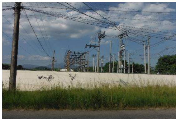
Figura 6.4.9-228 – Subestação no Bairro Campo Alegre. Município de Nova Iguaçu, RJ.
