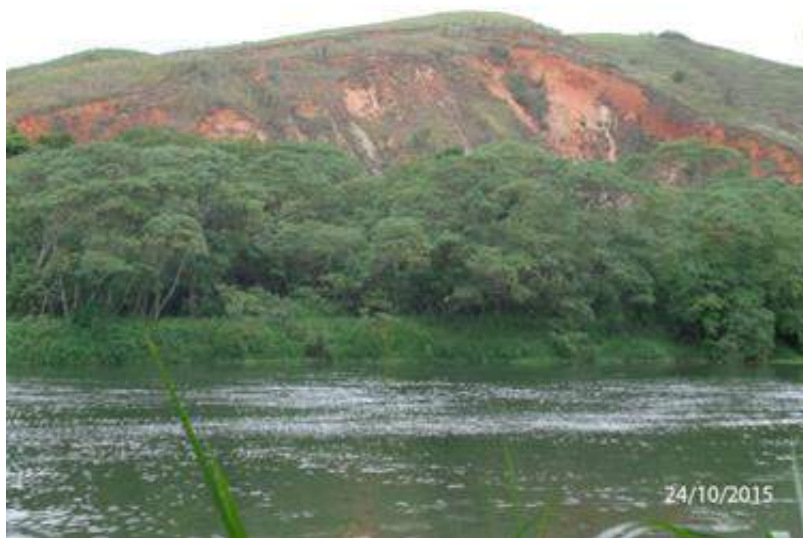
Figura 6.2.7-19- Argissolo Vermelho-Amarelo. Formiga / MG. Erosão na estrada de acesso. Fonte: SOS GEO. Localização: Coordenadas E 463916 e N 7735759 = Elevação 975m.
