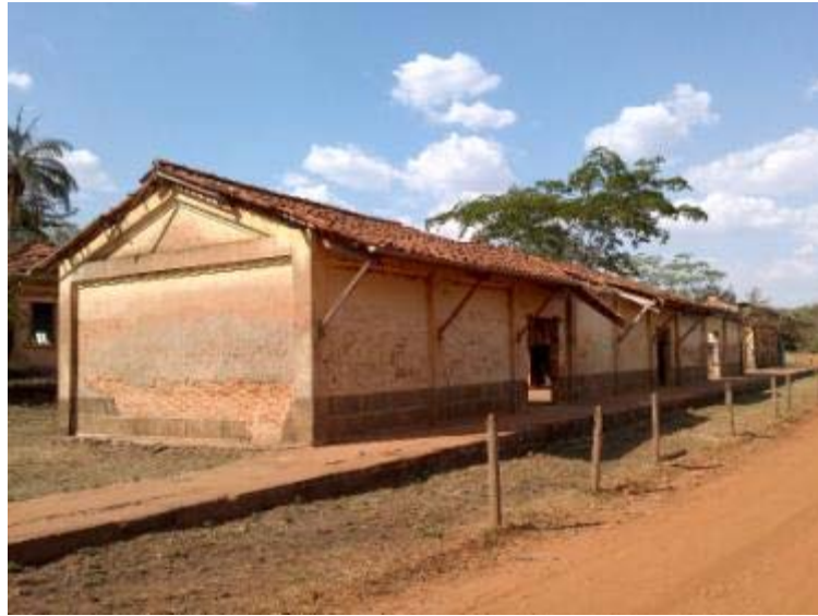
Foto 48: Estação ferroviária em Sacramento/MG, ou, ao menos, o que resta dela.
