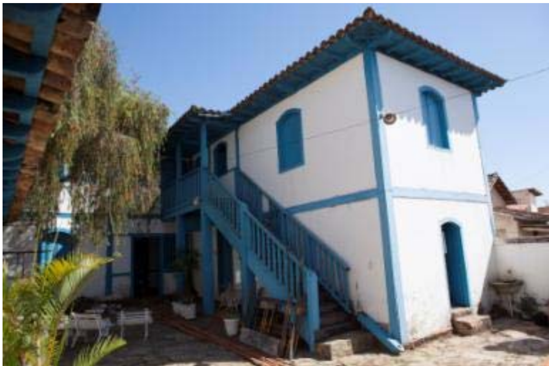
Foto 31: Parte posterior do solar. O imóvel atualmente encontra-se fechado e em reforma devida às precaríssimas condições em que se encontra.
