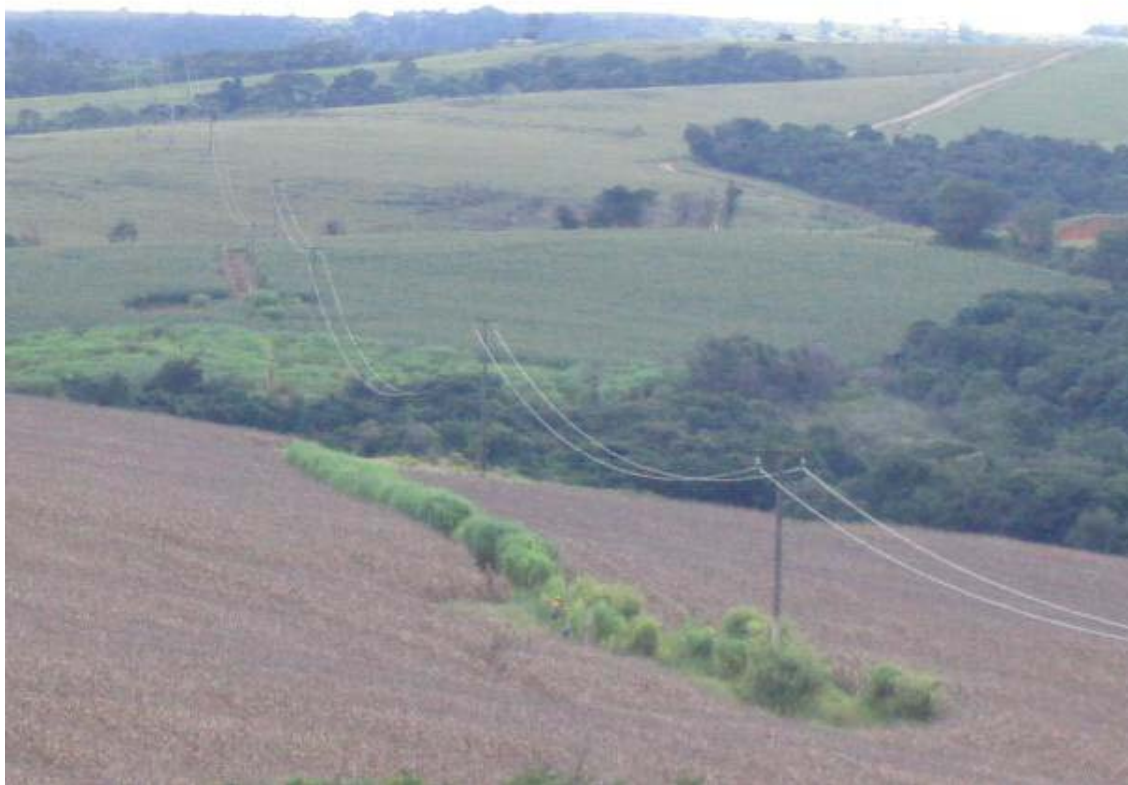
Figura 4.4.2.2.h Linha de eletrodo instalada nas proximidades da Estação Conversora de Ibiúna - SP
