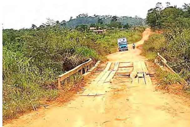
Figura 337 - Ponte quebrada na vicinal 5, na entrada da vila
