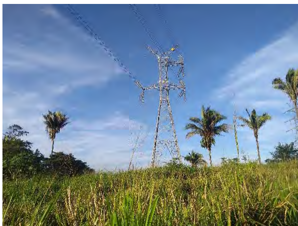
Figura 413 - Torres de Linhas de Transmissão nas vias de acesso ao PA Palmares.
