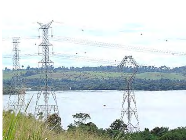
Figura 146 Travessia das LTs no rio Xingu, próximo a vila.
