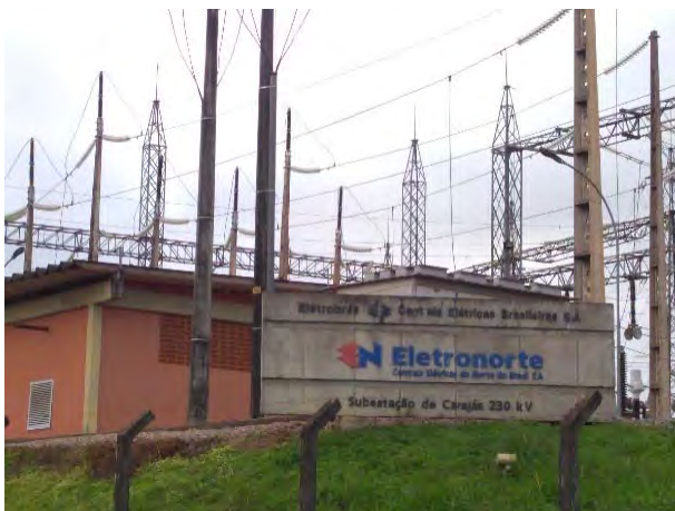
Figura 412 - Subestação Eletronorte na Rodovia Faruc Salmé.
