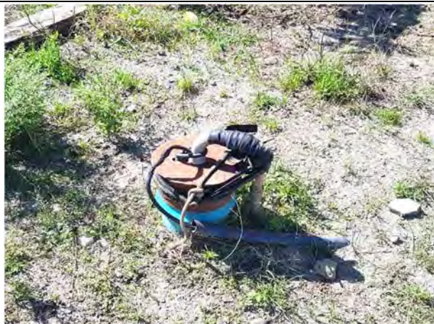
Figura 72 - Poço artesiano no PA Tuerê.
